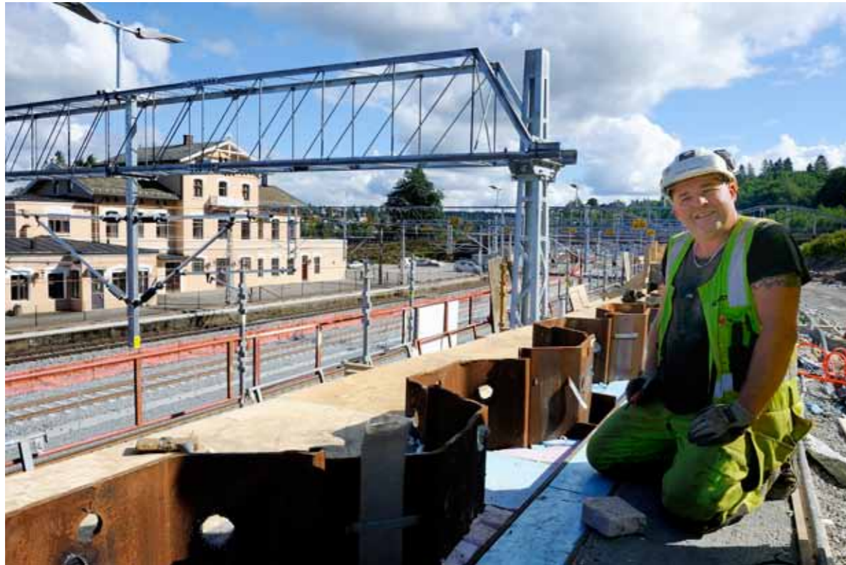
TRANGT: Jaroslaw Lewandowski foretar siste finpuss på den åtte meter høye spuntveggen som må bygges over sporområdet.
