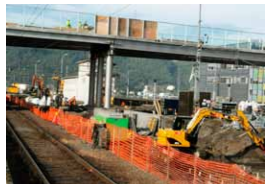
I HØYDEN OG PÅ BAKKEN: På Trondheim S arbeides det for tiden på to plan. Mens gang- og sykkelbrua Sjøgangen tar form over bakken blir det laget fundamenter for tunge bygninger under bakken.
