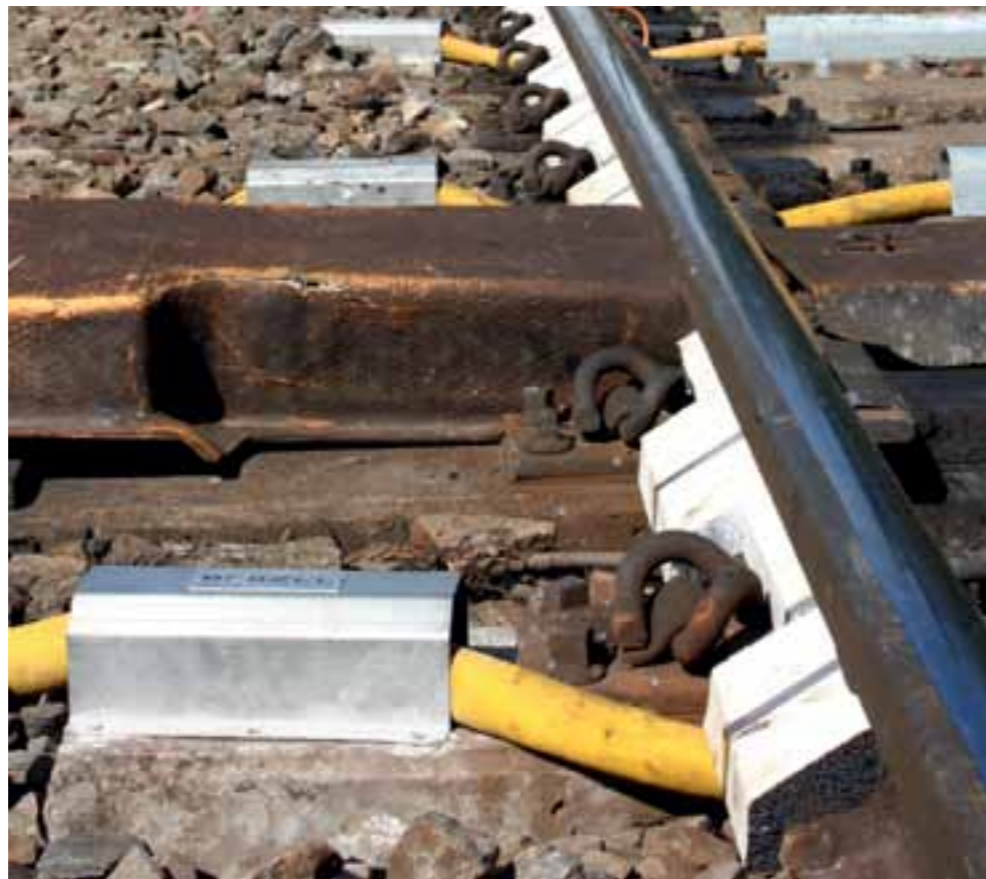
ISOBLOKK: Denne sporvekselen er isolert med isoblock, som bidrar til at varmen holder seg der den skal være.
