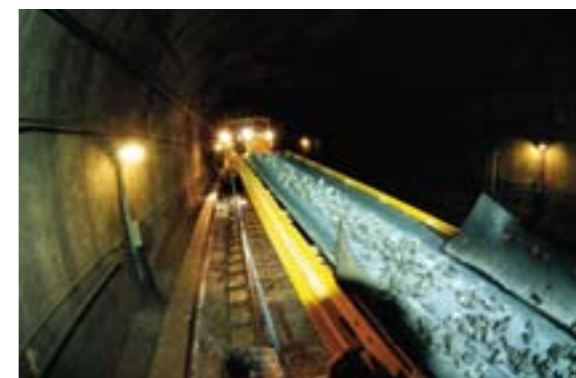
NYVASKET: Etter at forurenset, gammel pukk er støvsuget bort, kjøres nyvasket ballastpukk inn med spesialutstyr fra BaneService.
