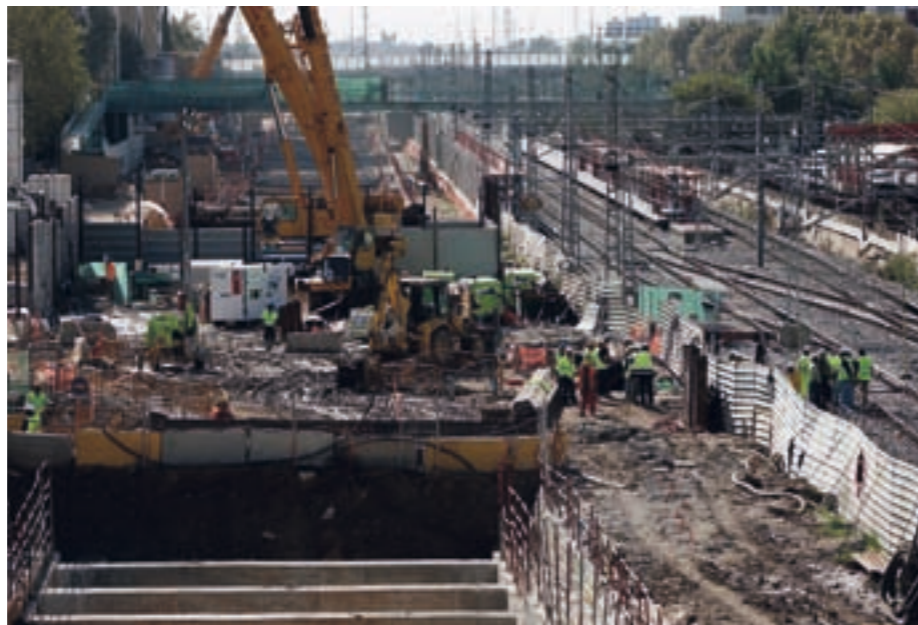
FORSINKET: Under Barcelona falt jorda sammen et tyvetalls steder ...
