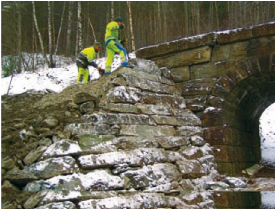
STOLT HANDVERK: Simen Haugrud frå JBV Drift (t.v.) og Stein Roger Rudi frå Jan Haugen AS i arbeid på kvelvingsbrua ved Rosten på Dovrebanen.
