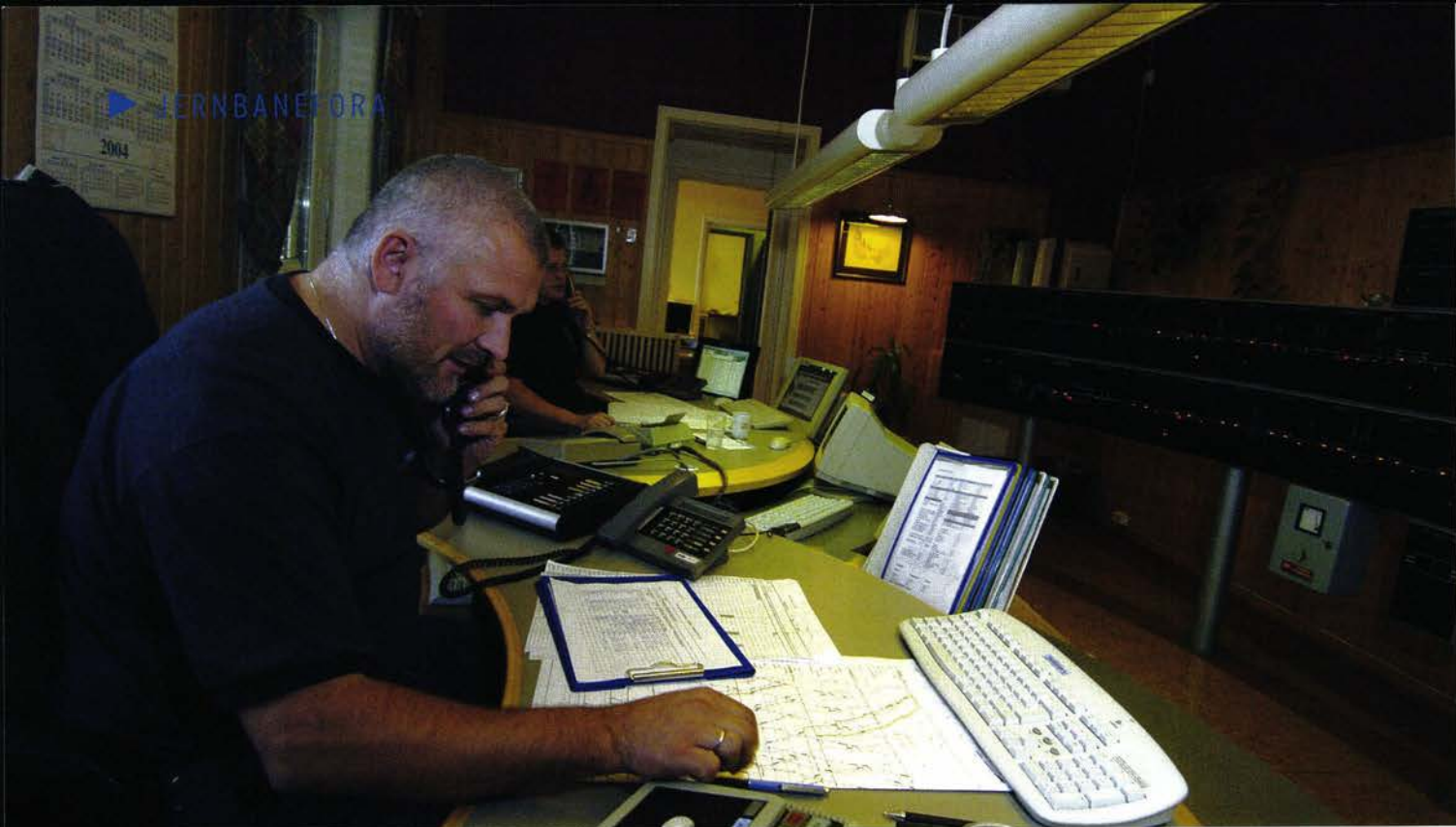
FJERNSTYRER: En stadig større del av Nordlandsbanen blir fjernstyrt fra togledersentralen i Trondheim.
