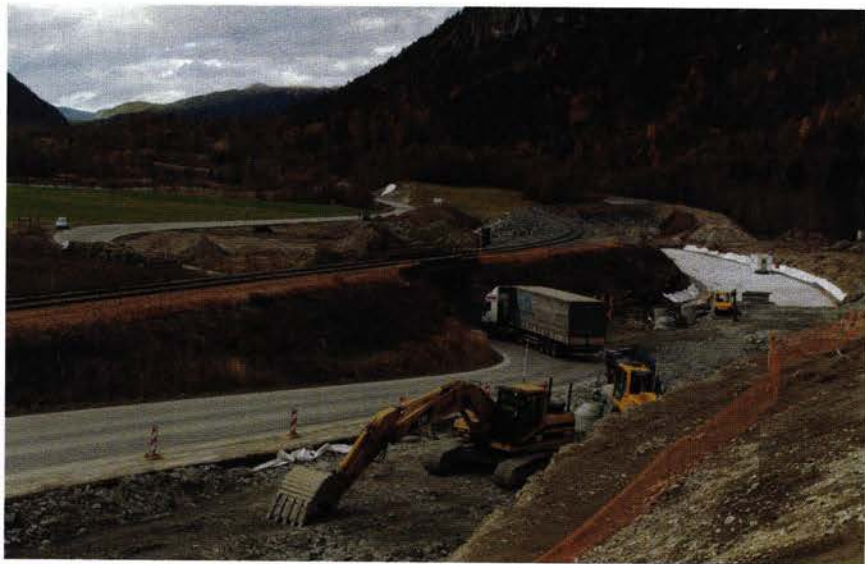
VEKK MED FIRE NÅLØYER: Når miljøkulverten ved Halså åpnes neste høst, vil Riksveg 135 bare krysse under Raumabanen ett sted, mellom Trollveggen og Åndalsnes.
