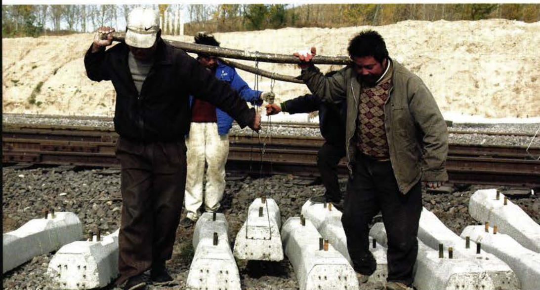
TUNGT: Et tungt loft. Betongsvillen skal flyttes til rett sted.
