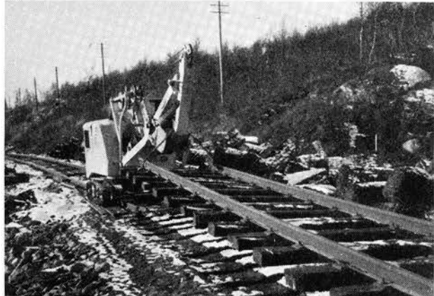
Fig. 6. Gravemaskinen løfter opp skinnelenken i den ene enden, mens den andre enden glir på underbyggingen som et foregående bilde viser, og videre på den liggende skinnegangen, etter hvert som gravemaskinen skyver den fram.
