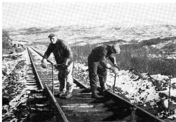
Fig. 8. Samtidig som trauret graves og torvbuntene legges på plass, skiftes de uimpregnerte svillene på den uttatte skinnelenken.
