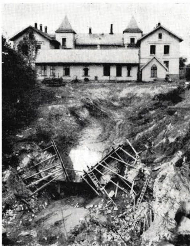
Sykehuset som måtte fjernes. Bildet viser også en renne som ble benyttet for å kunne dose jord direkte i dumperne.
