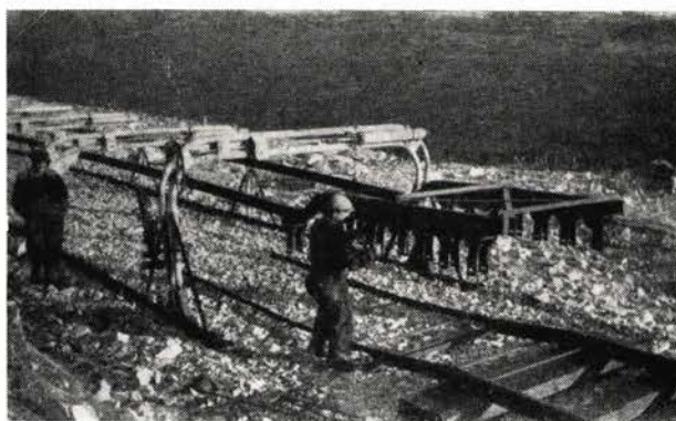
Fig. 10. Utleggerapparatets bakre ende. I forgrunnen nedløpsanordning for tomtraller. Løpekattene gjøres klare. På hver bøyle er 2 sylindre (8 bøylor — 16 sylindre) som senker de to løpebjelker når lenken ved hjelp av de 16 løpekatter er skjøvet helt inn.
