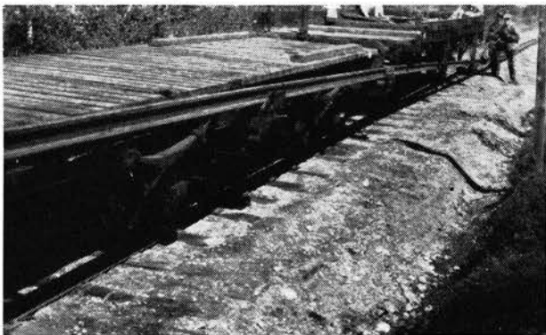
Fig. 6. Det kjøres fram, og mannen passer på at skinnestrengen legger seg pent på svilleendene.
