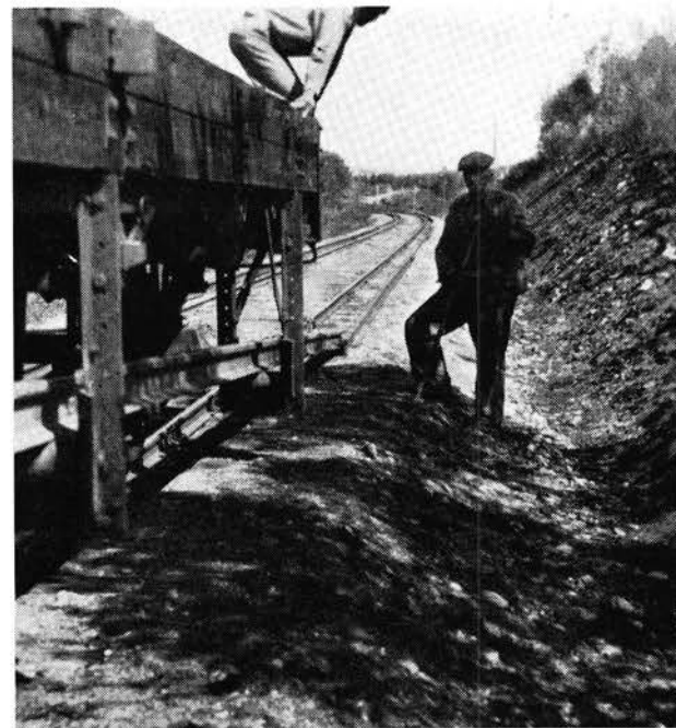
Fig. 9. Bakerste utkjørvogn med skinne nedtrukket på ruller og festet med kjetting til skinnegangen.
