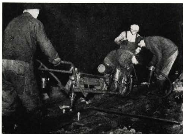
Fig. 2. Skinnen festes på hver 5.—6. sville ved hjelp av en kombinert skru-boremaskin. Spormål pålagt.
