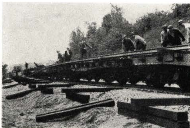
Fig. 7. Sideveis avlastning av ca. 450 m langskinner ved Schenectady i New York (Delaware and Hudson Railroad Corporation).
