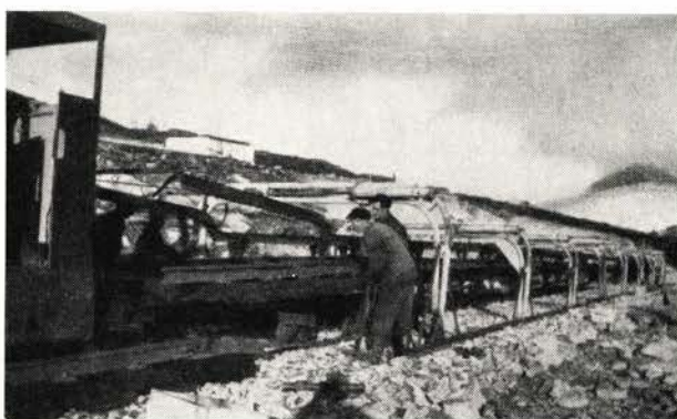
Fig. 14. Lenken er helt inne. Dieselloket tar nå de 4 frigjorte traller tilbake til kranene. Etterat nedløpsanordningen er fjernet, kan nå lenken senkes ned i sitt endelige leie på kultlaget.
