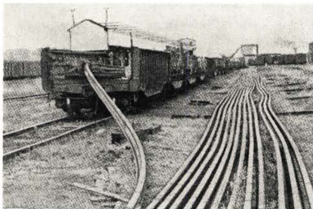
Fig. 4. Opplasting av 1560 ft (ca. 475 m) langskinner på 29 vogner ved Silvis i Illinois (Chicago, Rock Island & Pacific Railroad Co.) Vognene skyves under skinnene. Skinnene, som føres gjennom et «nåløye» montert på bakerste vogn, holdes igjen i den ene ende av en solid fundamentert portalkonstruksjon.
