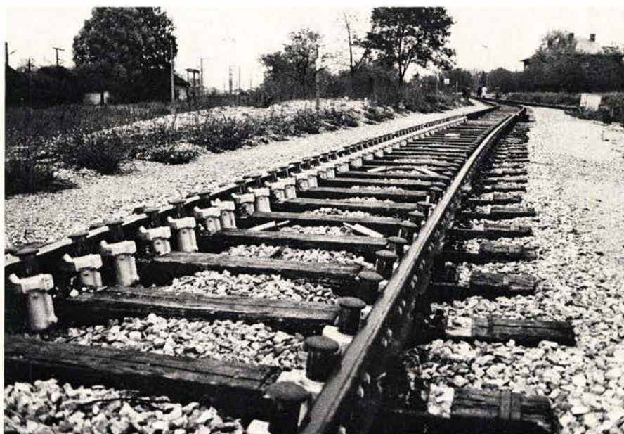
Fig. 5 Retardasjonssone med stor tetthet av bremseelementer.
