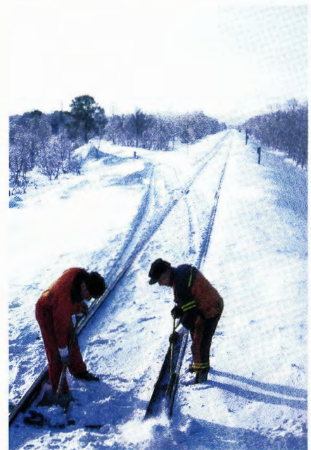
Det er viktig at sporveksler er skikkelig rengjort for snø. I dag benyttes innlagte varmelementer for å tine veksleene etter behov. (Foto i 1988: Kim H. Gundersen.)
