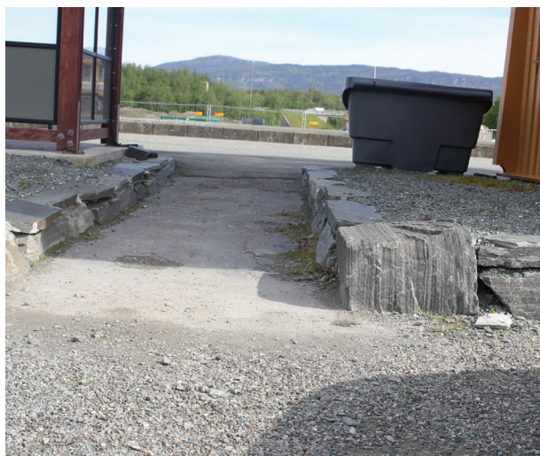
Figur 33 Hell stasjon, Nordlandsbanen. Grus og asfalt er en salig blanding på denne stasjonen. Dette gir et lite pent estetisk uttrykk. (Bredevold, 2015)
