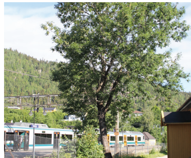
Figur 46 Hvalstad stasjon, Vestfoldbanen. Trærne har greiner nær kjøreledningen. (Larsen, 2015)
