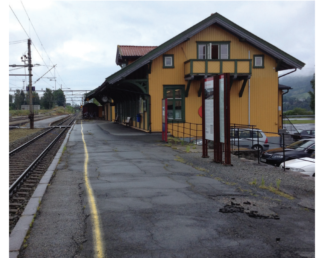
Figur 23 Vikersund stasjon, Bergensbanen. Stasjonen har et grått og lite innbydende uttrykk, da nesten hele stasjonen er asfaltert. Asfalten er i dårlig stand.
