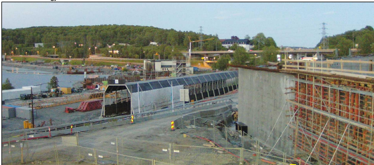
Figur 5-54: Eksempel på beskyttelsesskjerm i anleggsfasen. Fra riggområdet på Farriseidet hvor E18 og jernbanen krysser hverandre. Foto: Statens vegvesen
