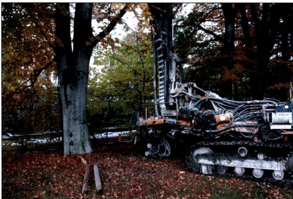
Boring på Gamlebyen gravlund, nær skjæringen til dagens Østfoldbane (med tog) i Lodalen. Foto Petter B. Molaug, NIKU.
