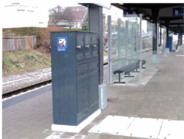
Perrongapparatkasse (PAK) med kabelstøttepunkt
