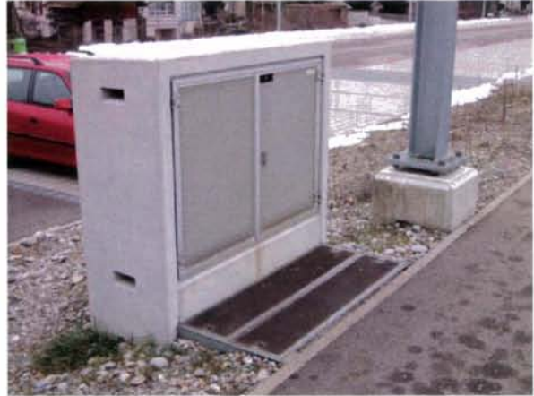
For å komme til elektriske anlegg (belysning, klokker, høyttaler, telefoner osv.) på plattformene, benyttes en apparatkasse av betong (perrongapparatkasse – PAK)
