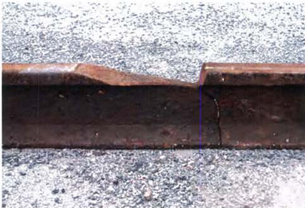
Figur 1: Skinnebruddet fotografert etter uttak fra sporet. (Foto: JBV).
