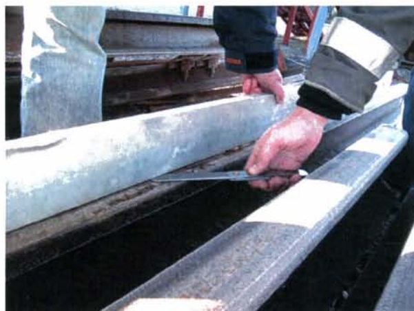
Figur 4: Måling av nedsenkning på kjørebanelen ved hjelp av linjal og bladsøker.
