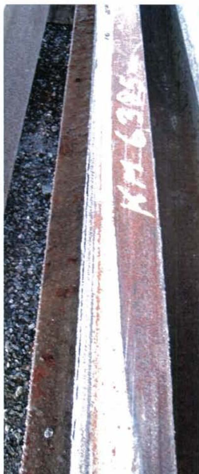
Figur 3: Skinne med tydelig korrosjonsskade på kjørebanelen.
