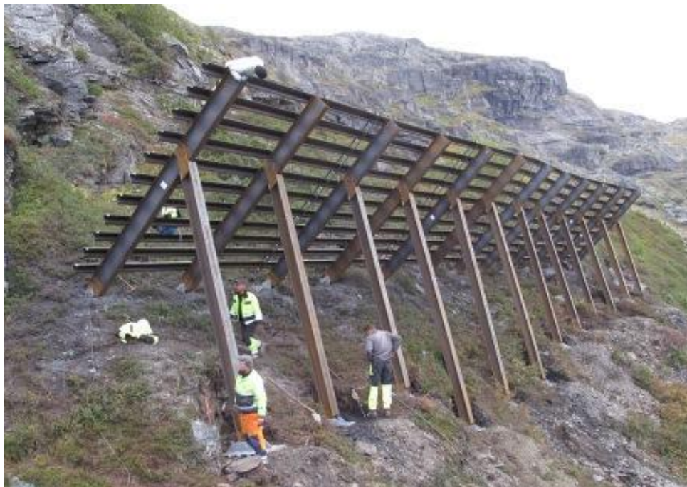
Figur 3-4 Rassikring på Bergensbanen 2010 [22]
