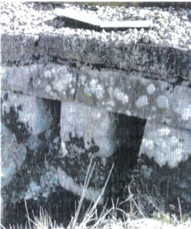
FIGUR 2-5 Dobbeltløpet stikkrenne hvor det er problemer med at ballast raser inn i stikkrenna. Det er gjort en foreløpig utbedring ved å legge inn ei isolasjonsplate i underkant av ballasten for å hindre nedrasing. Km 14,525
