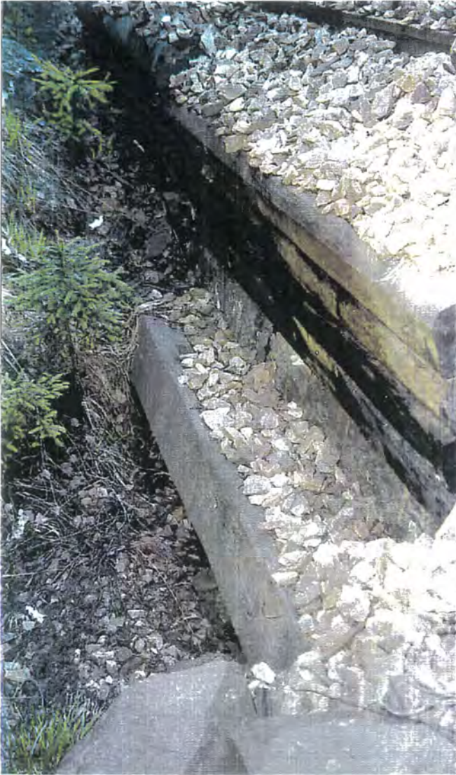
FIGUR 2-12 Svillemur som er presset utover, og øverste sville har rast ned i stikkrennas innløp. Km 193,87
