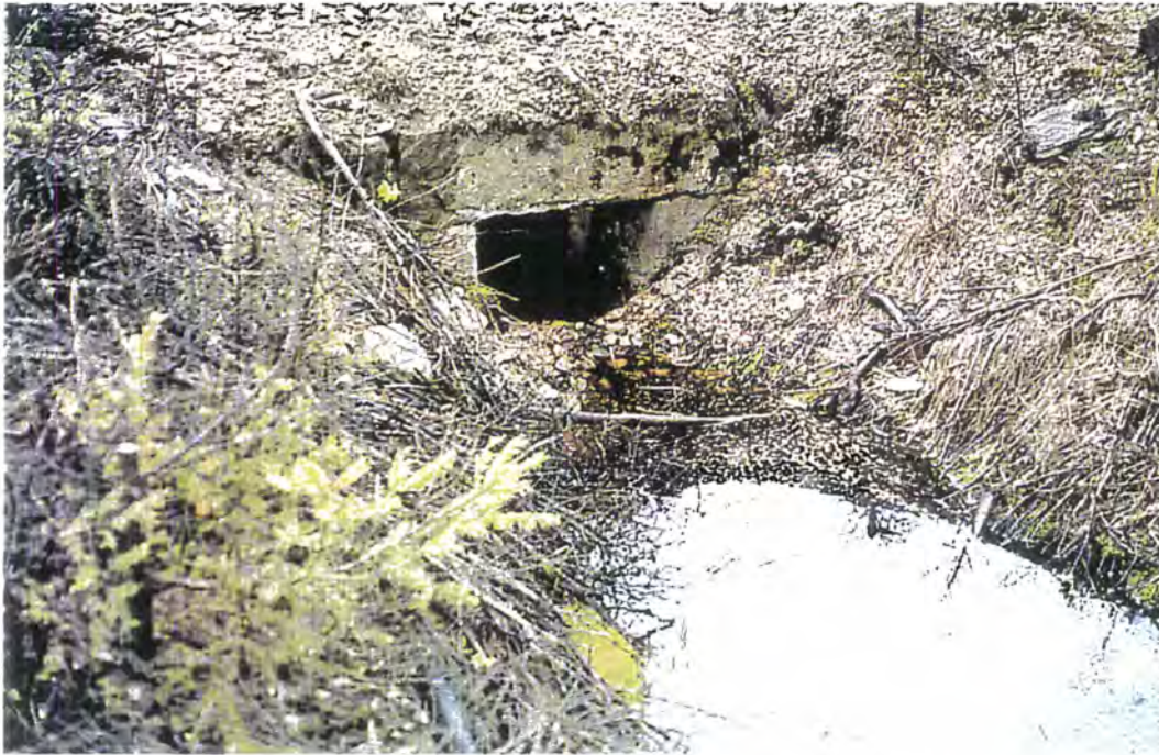
FIGUR 2-10 Steinrenne hvor ballastpukk og grus har rast ned foran munningen. Km 150,320
