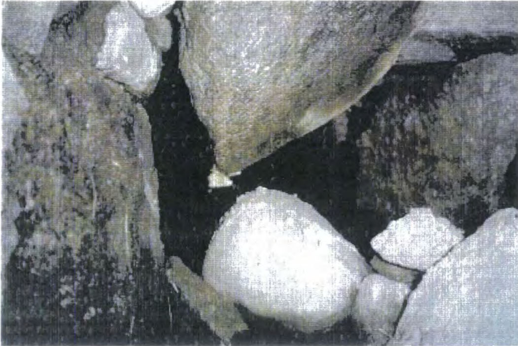
FIGUR 2-4 Stikkrennas tverrsnitt er delvis tettet av større steiner som har rast inn. Km 15,131
