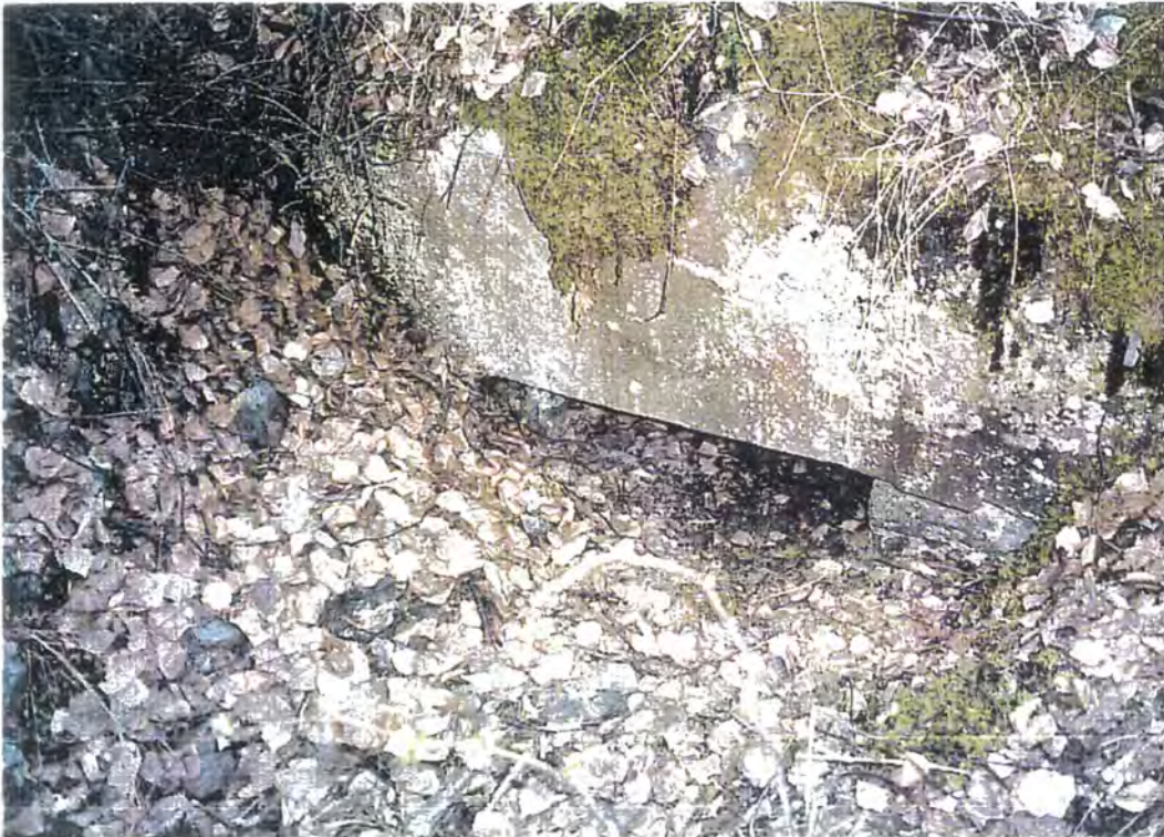
FIGUR 2-13 Stikkrenne som er gjenslammet med finere masser og løv fra trærne. Km 193,395
