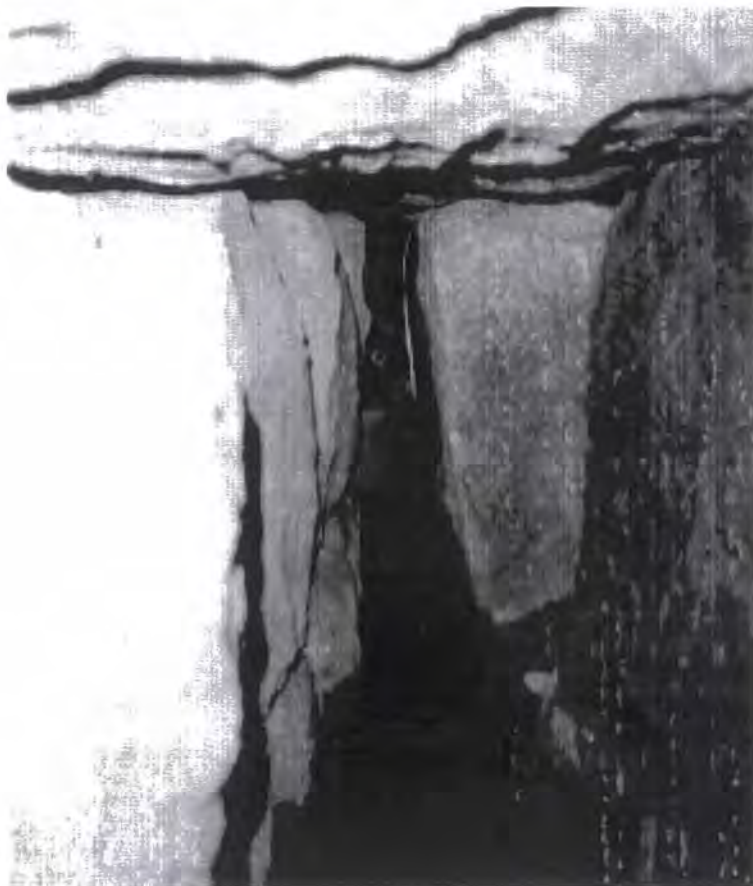
FIGUR 2-6 Steinrenne med sterkt innsnevret tverrsnitt grunnet innpressing av en av sidesteinene. Km 15,525
