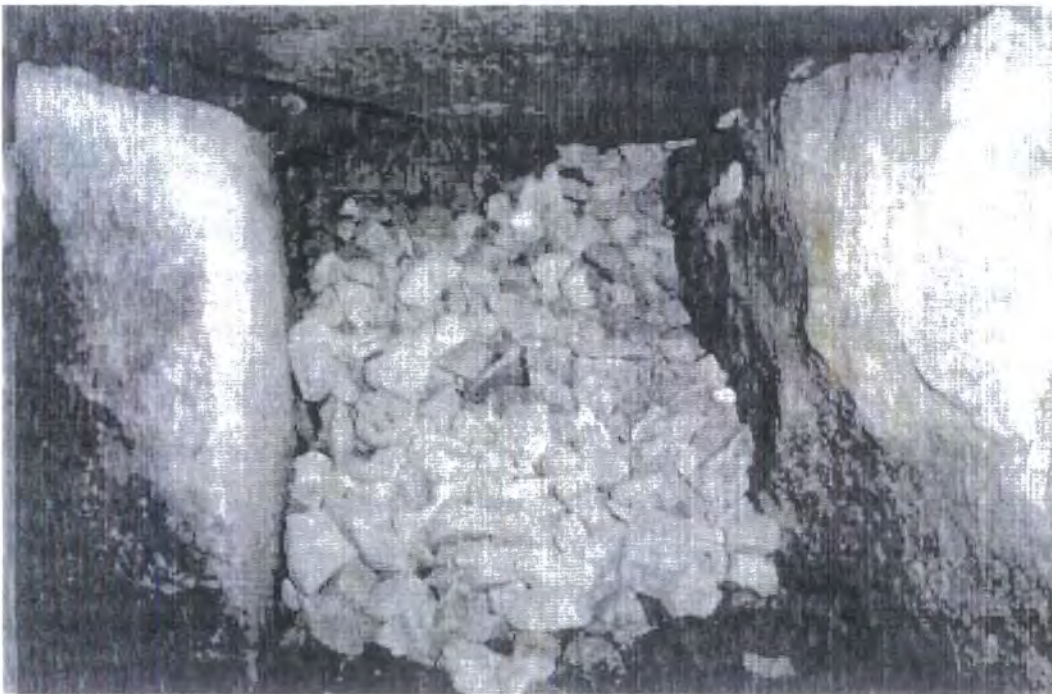
FIGUR 2-3 Stikkrennas tverrsnitt er helt tett grunnet ballast som har rast inn. Km 15,061
