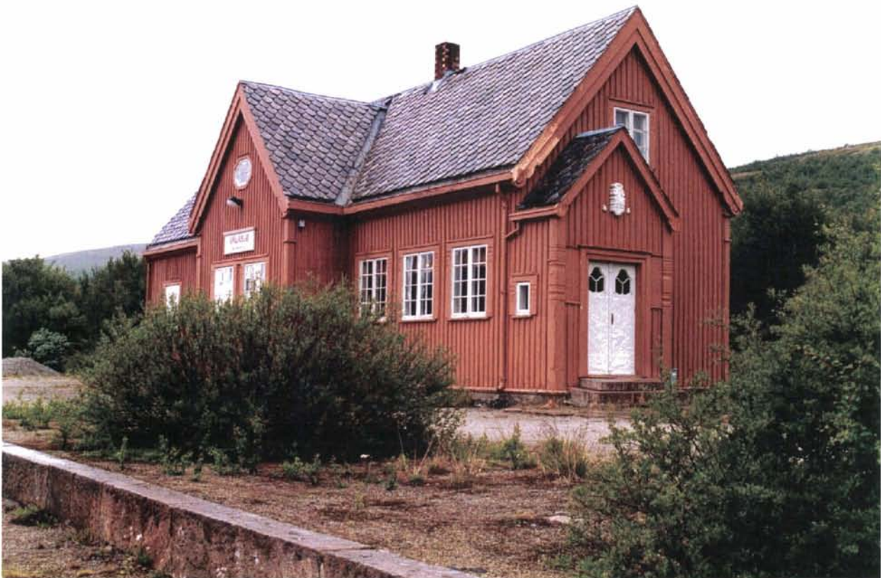
Foto 9: Vålåsjø stasjon. Bak ekspedisjonsbygningen ligger uthuset med privèter bygd i samme formspråk. Okerfargen skjuler flere spennende bygningsdetaljer og utskjæringer som med fordel kan bringes fram gjennom en mer variert og bevisst fargesetting.
