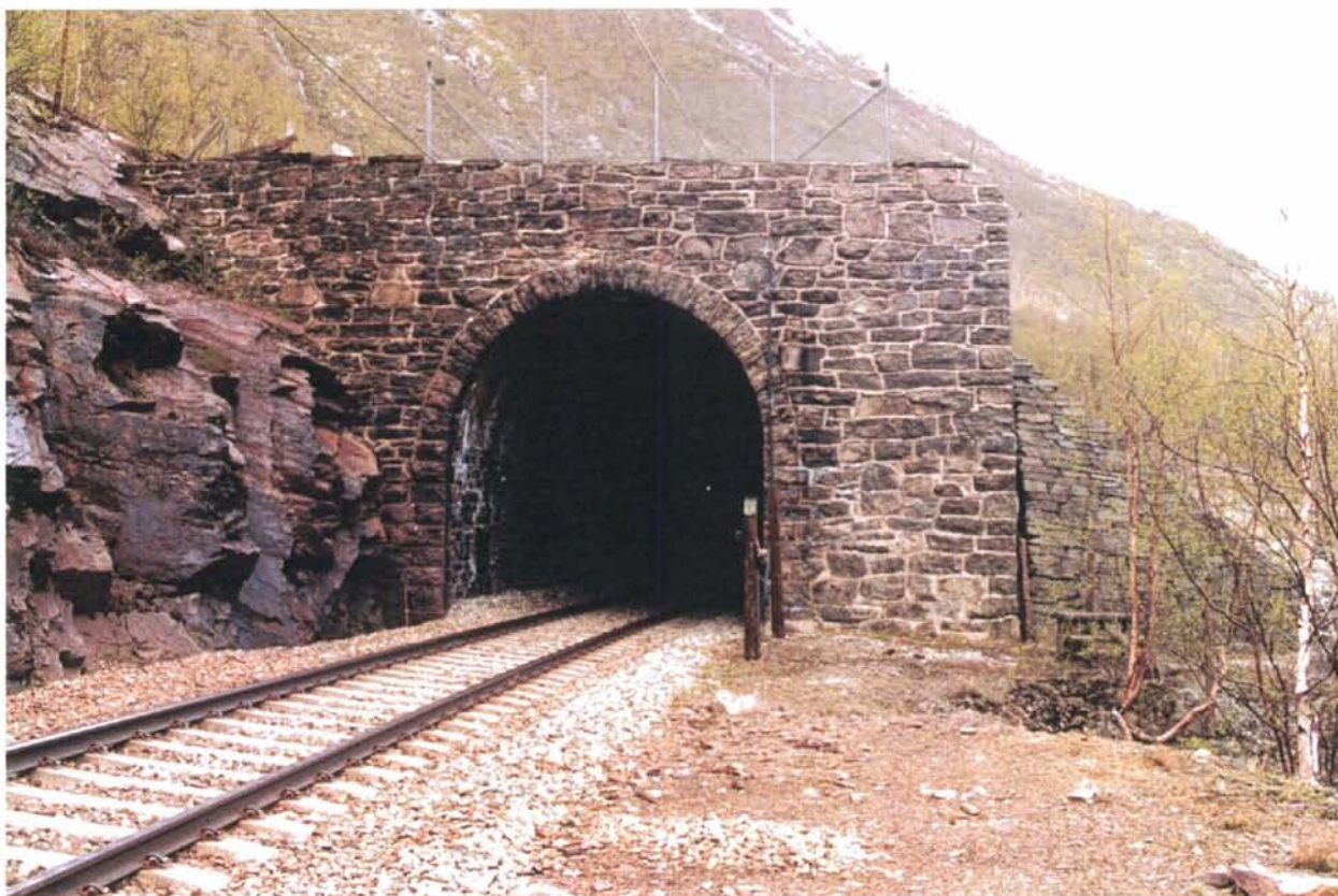
Foto 51: Nystubekk tunnel har en usedvanlig flott forblendet frontvegg med kvadersteinsomramming. Om mulig bør portalen bevares. Senking av sporet må vurderes før man eventuelt finner på å rive dette flotte portalbygget.
