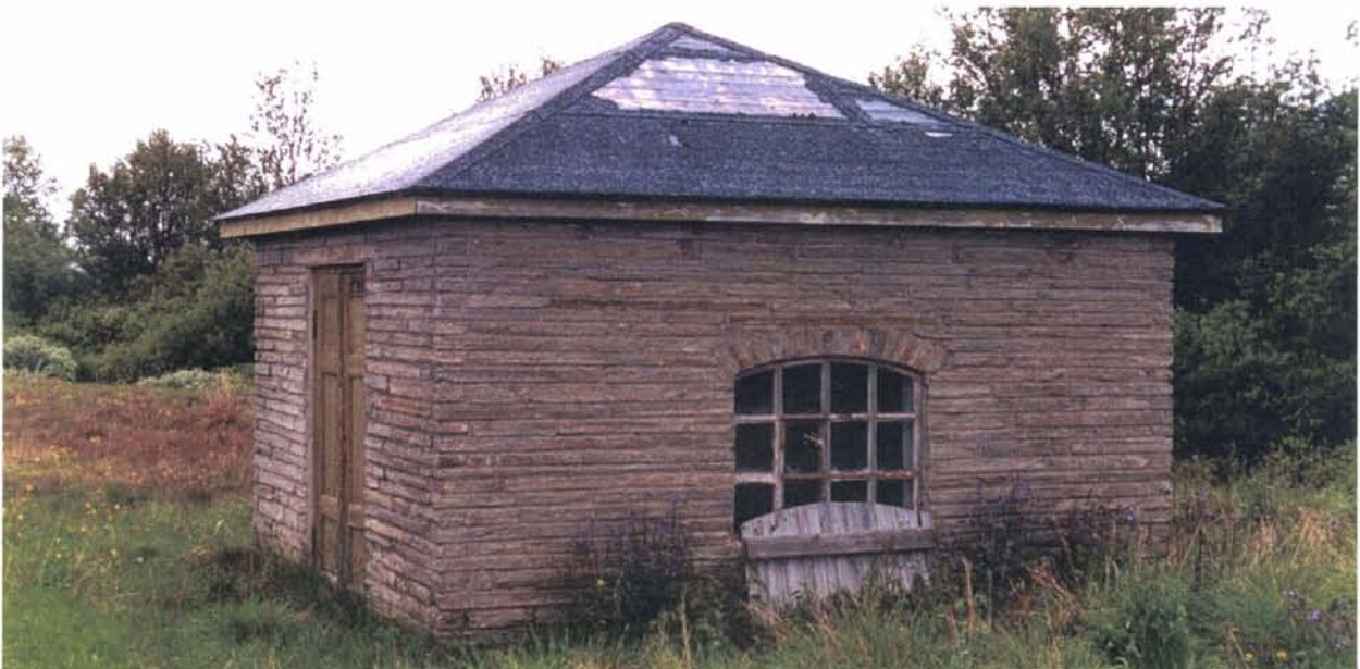
Foto 59: Kraftverkhuset på Fokstua, står fortsatt. Huset er for lengst tømt for teknisk utstyr slik at kraftstasjonens verdi som teknisk kulturminne er forspilt. Huset kreves ikke satt i stand, men steinmurene anbefales tatt vare på som en del av kulturmiljøet ved Fokstua stasjon.
