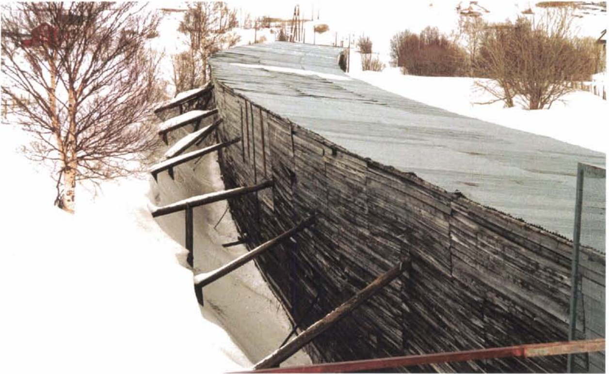
Foto 54: Snøoverbygget ved Risgrenda, km 420,80-421,02, har fått en patina i stil med de solsvidde bygningene på gårdene omkring og er derfor visuelt sett lite påtrengende. Ved fornyelse av anlegget må de estetiske og landskapsmessige sidene ved oppgaven vies oppmerksomhet.
