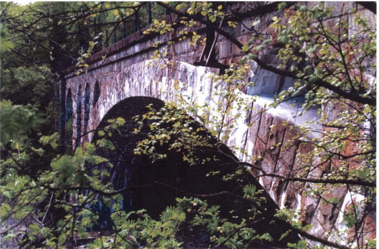
Foto 35 og 36: 80 års patina gjør at Gulfoss bru er enda vakrere i dag enn da brua sto ferdig i 1918. Dette er en av de mest severdige bruene på det norske jernbanenettet og fortjener en mer eksponert utstilling i landskapet gjennom tynning av vegetasjon.
