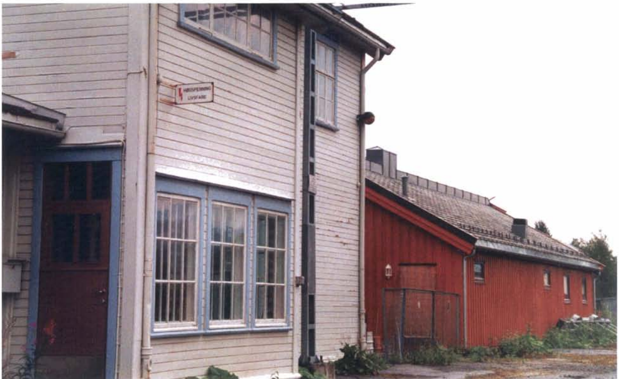
Foto 21: Melhus stasjon er i dag et trist syn for melhusbygger som husker dette tradisjonsrike anlegget så sent som på 1960-tallet. Stasjonen kan framstå som eksempel på hvor sårbare disse gamle stasjonsmiljøene er for en etterbruk som ikke viser respekt for historien, arkitekturen og det opprinnelige miljøet. Melhus stasjon må ansees som tapt for kulturminnevernet, også stasjonsbygningen som har gitt sitt navn til en av de aller første prototypene på det norske jernbanenettet.
