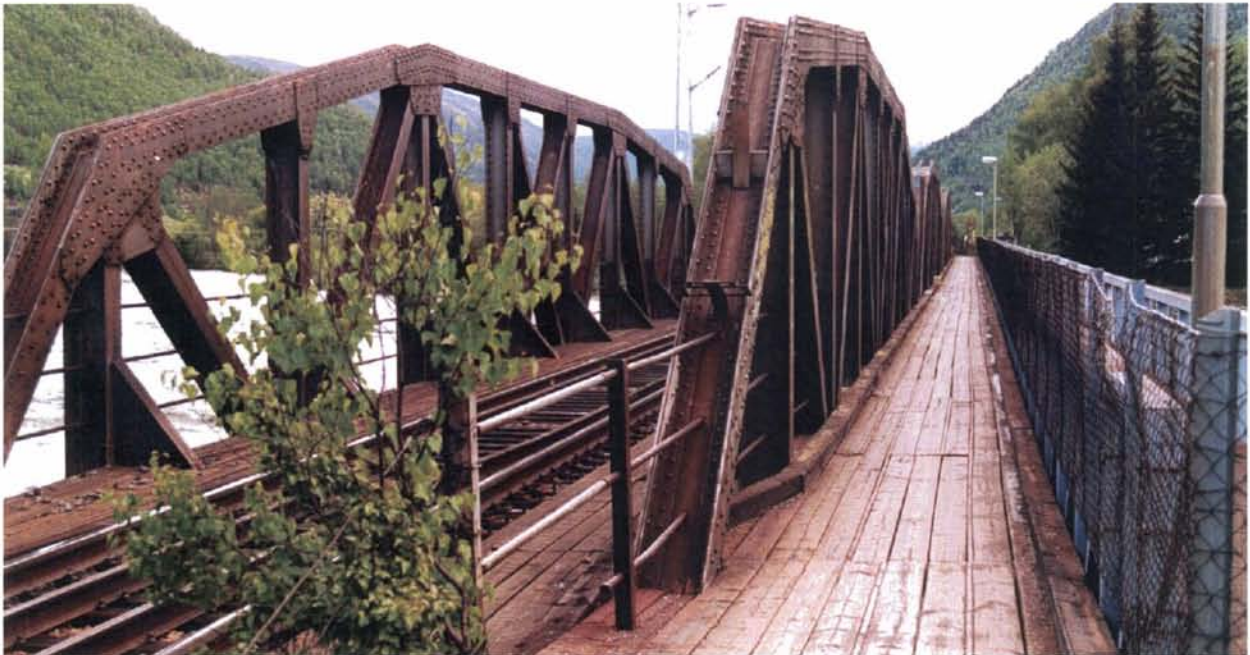
Foto 51: Otta bru er et landemerke og samferdselshistorisk kulturminne av betydning. En forsterkning av fagverket utført i 1948 har ikke endret bruas estetikk. Det har derimot en påhengt kabelkasse for kommunale kabler og ledninger som er blitt for dominerende i forhold til bruas proporsjoner. Brua er et potensielt verneobjekt.
