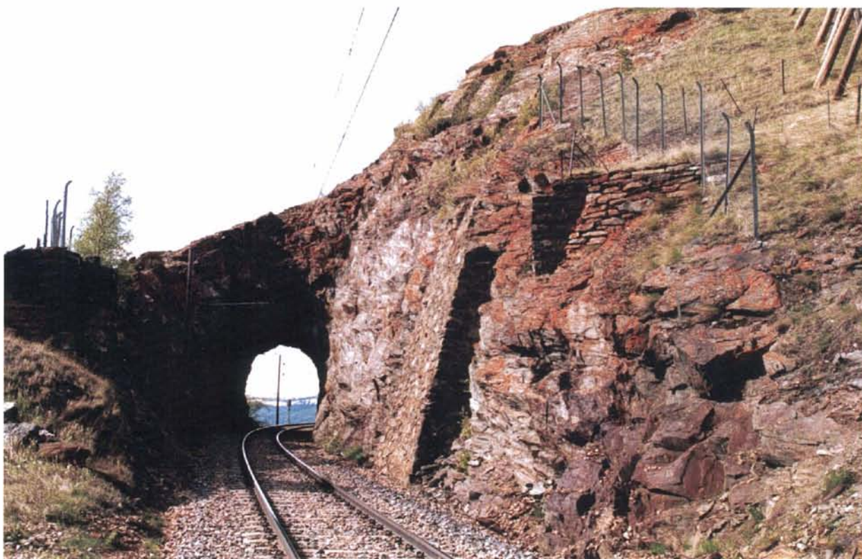
Foto 60: Skjelle tunnel, km 341,01, med sine terrengmurer er vakkert tunnel- og murarbeid fra den tid alt arbeid forgikk for hånd. Tunnelen foreslås tatt vare på som et lokalt kulturminne.
