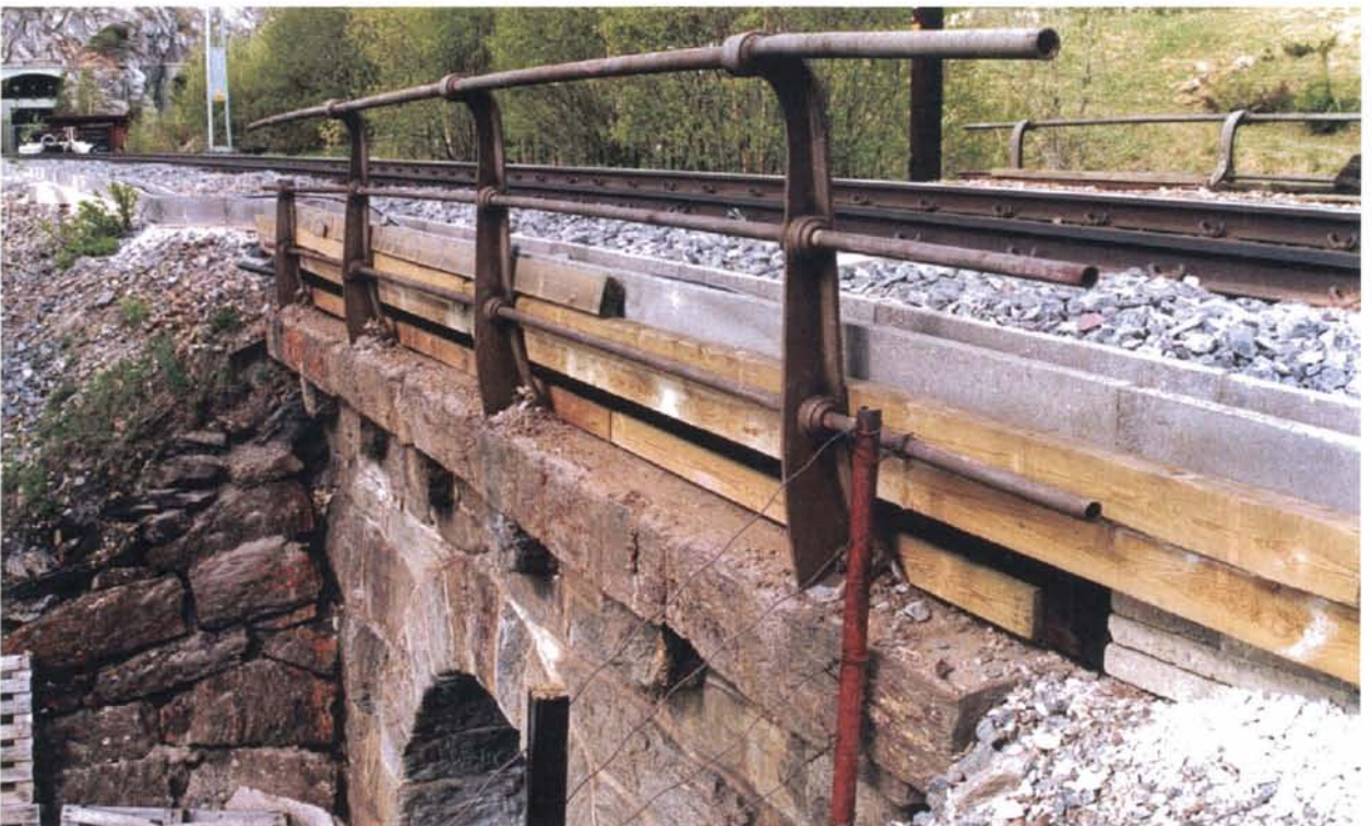
Foto 55: Tilpasningsproblemer mellom nytt og gammelt, her representert ved en overbygning som er blitt liggende for høyt i forhold til en gammel steinhvelvundergang. Eksemplet er hentet fra Dombås, km 342,21, men tilsvarende tilpasninger finner man overalt. Problemet må vies større oppmerksomhet i banevedlikeholdet.
