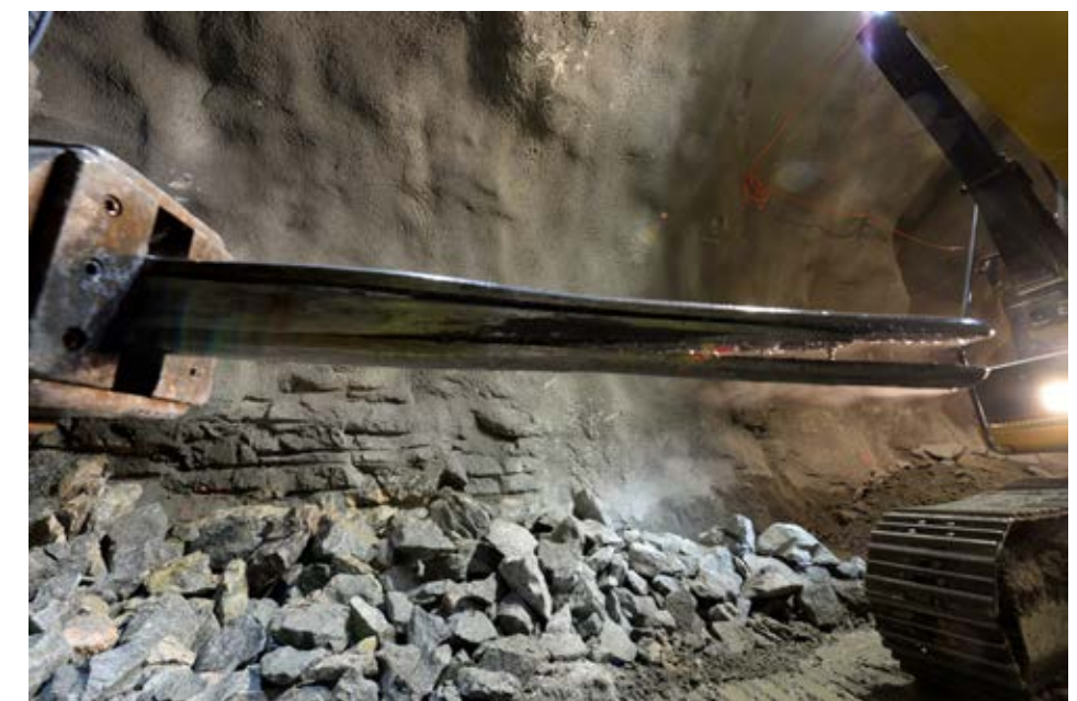
Italienske tunnelspecialister anvender «Drill & split» – eller mekanisk bergbryting – til å drive adkomsttunnel til Follobanen i Ekebergåsen fra Sørenga. Etter at en borerigg har boret inntil 500 hull, brukes en såkalt Superwedge splitter utstyrt med en kile på om lag en meter. Metoden forårsaker ikke rystelser, men den er tidkrevende. Framdriften er bare en meter i døgnet mot 10-15 meter ved vanlig sprengning.
