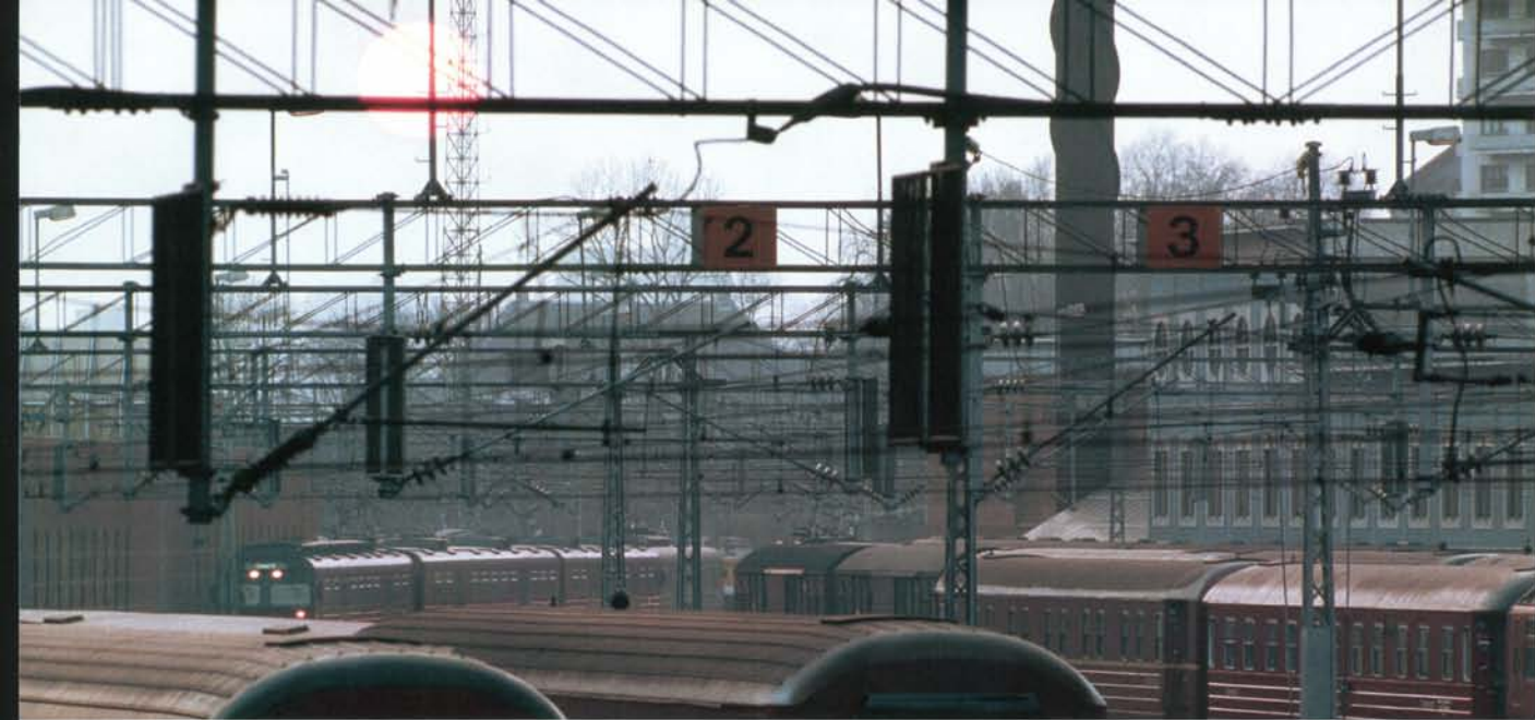
Kontaktledningsanlegget må være nytt når det skal tilrettelegges for hastigheter på 160 km/time eller mer (Foto: Rune Fossum)
