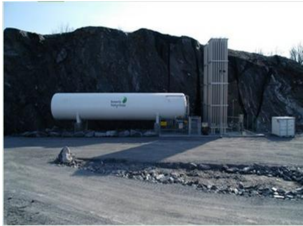
LNG Terminal in Bodø
