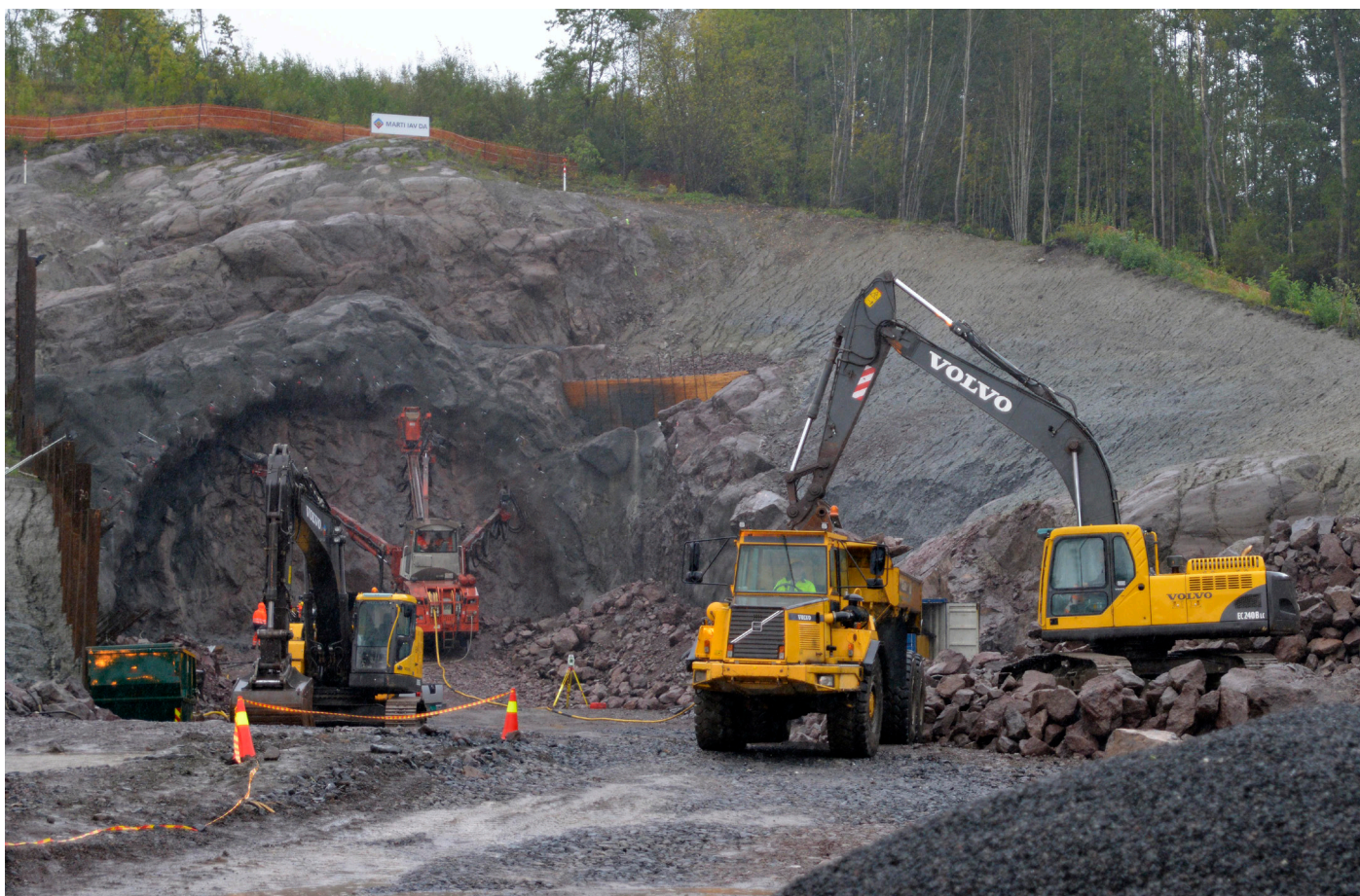
Tunneldriving fra Fegstad er i gang. Det skal drives ca. 10 meter fra denne siden før vi starter bygging av betongportalen. Foto: Trine K. Bratlie Evensen/Jernbaneverket
