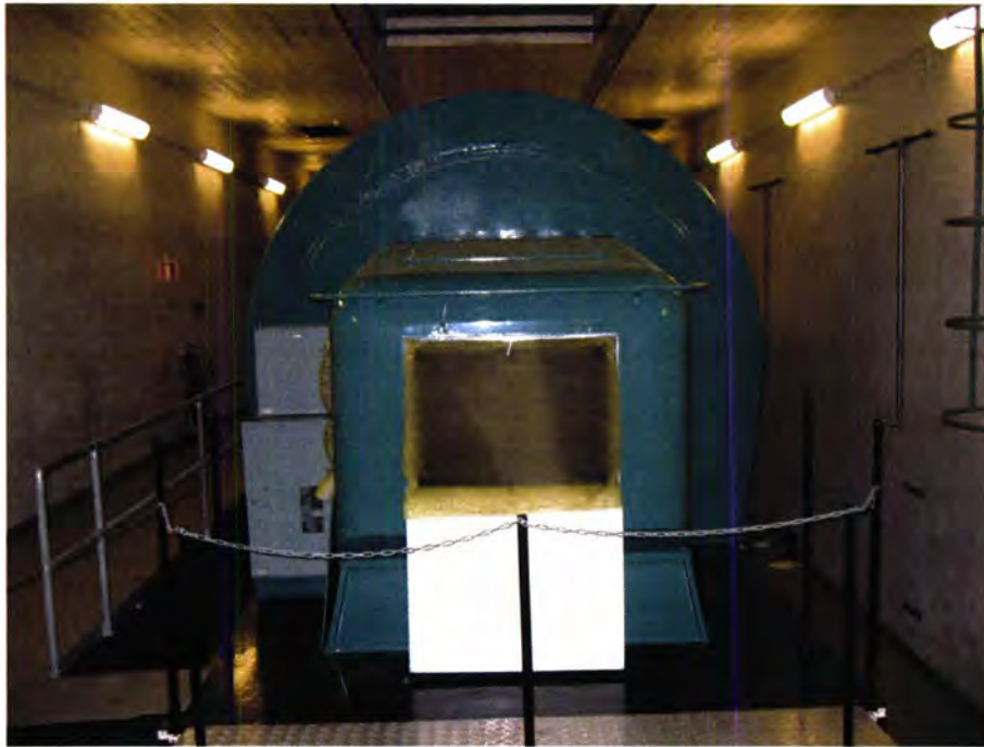
Figur 3: En 5.8 MVA roterende omformer i en omformerhall på Oppdal omformerstasjon
