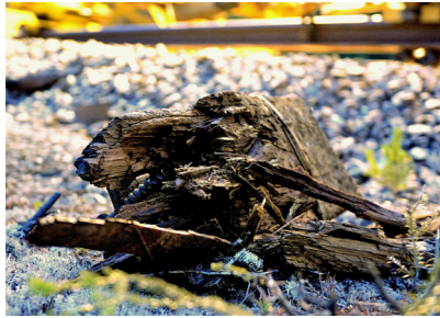
RÅTNE: Etter mer enn 50 år på Rørosbanen er tilstanden på mange kreosot-impregnerte tresviller preget av lang tjenestetid.
