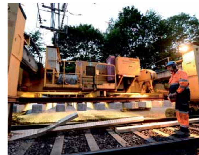
FULL KONSENTRASJON: Reidar Haugland i Norsk Jernbanedrift følger med når kranfører Gunnar Seves i Baneservice manøvrerer den store, beltegående kрана med sporvekselen hengende under buken.
