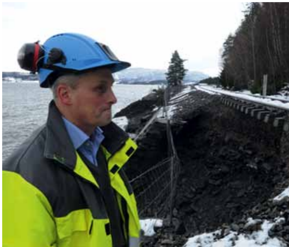
HARDE TAK: Orkanen Dagmar slo til med vill vrede og knuste den 120 år gamle støttemuren i Muruvik. Assisterande banedirektør Brede Nerموen kan berre slå fast at det vil ta lang tid og koste mange pengar å få banen i orden att.
