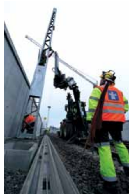
REISING: KL-montører fra Norge, Sverige og Danmark reiser seks meter høye KL-master på Barkåker.
