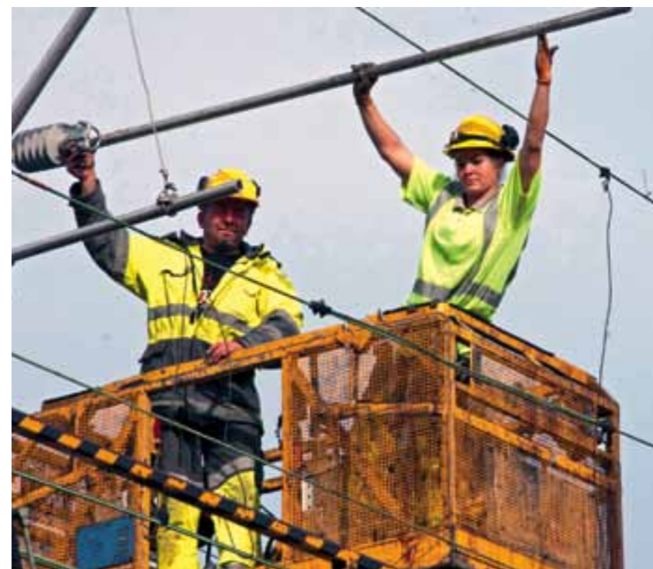
FORNYER: Lærling i energimontørfaget Linda Torrissen bytter ut et skadet åk med et nytt på Kongsvinger stasjon sammen med energimontør Per Krisian Lund.
