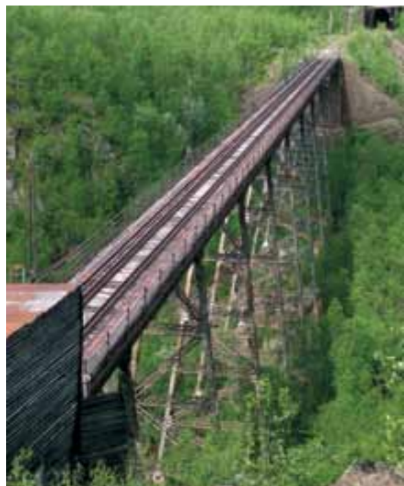
GJENÅPNES: Er den snart 110 år gamle Norddalsbrua fremdeles i god nok stand til å tåle togtrafikk? Det spørsmålet skal nå utredes.
