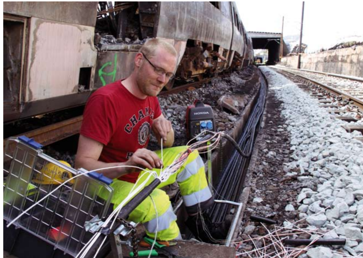
SKJØTER: Signalmontør Espen Rosnes skjøter signalkabler på Hallingskeid stasjon med det utbrente togsettet i bakgrunnen.
