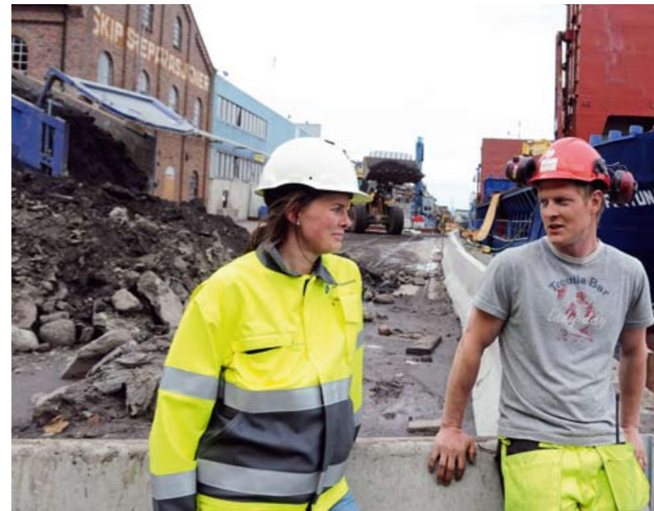
STRENG: Byggeleder Elisabeth Leirvik Rabben sjekker at Tommy Skar og Grunnarbeid AS har kontroll på at all kreosotmassen blir med om bord.
