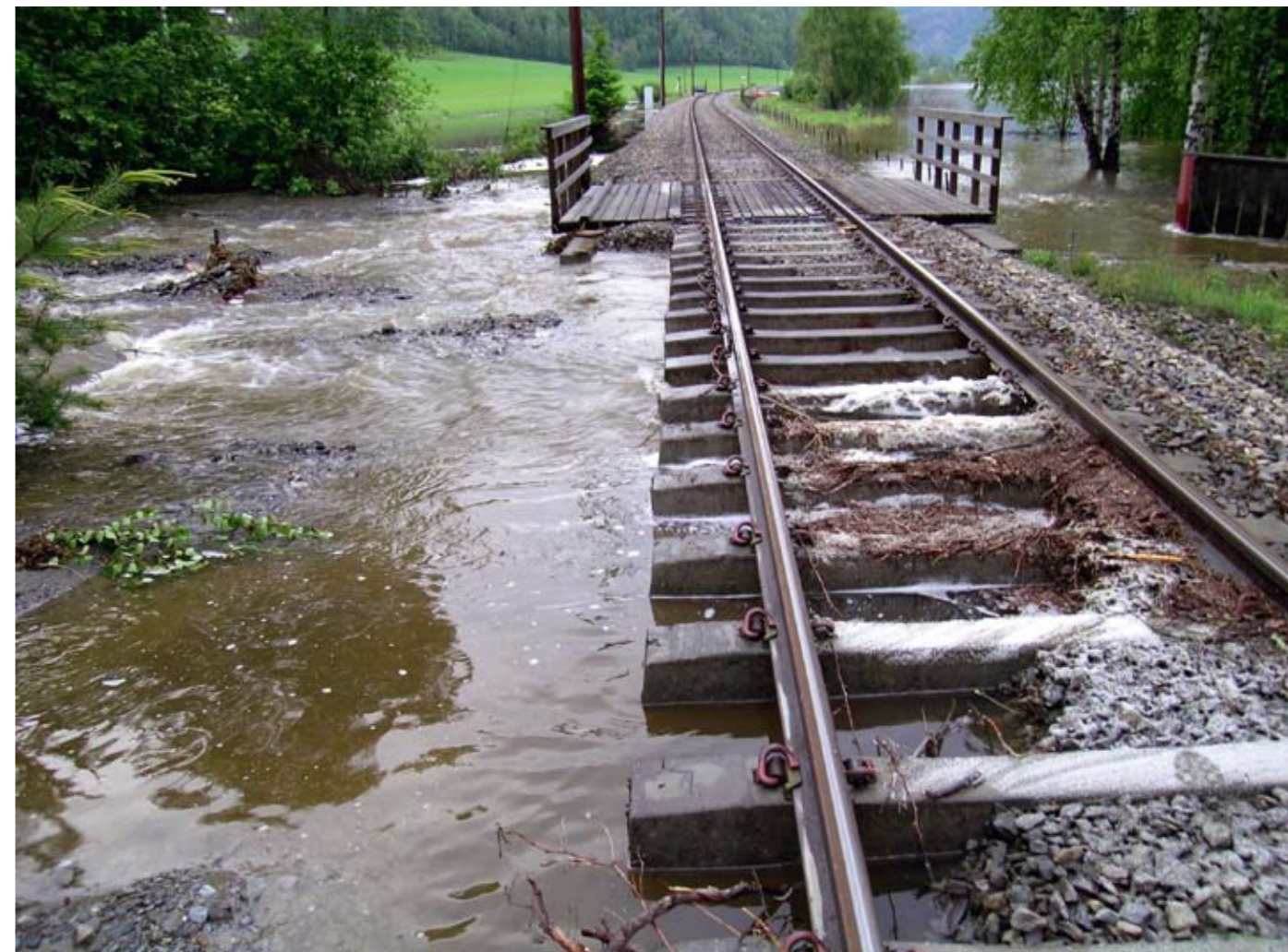
LØPSK: Denne bekken ved Sandbru gård sør for Otta rant over sine bredder og rev opp en 50 år gammel bjørkeallé. Plutselig var vannveien under Dovrebanen ut i Lågen kraftig underdimensjonert.
