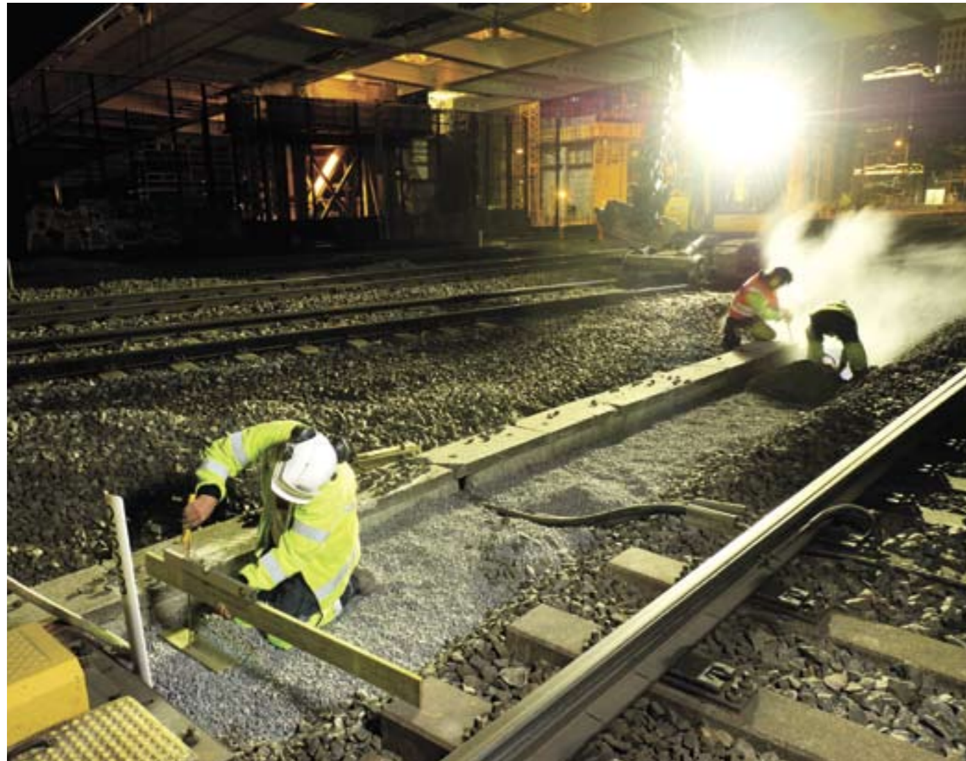
NOYAKTIG: I løpet av vinteren og våren er det gjort et betydelig nattarbeid på Oslo S og i Brynsbakken. Blant annet er det bygd flere kilometer med kabelkanaler. Når Prosjekt Oslo er ferdig neste år, skal det være strukket 55 kilometer med nye telekabler og hele 400 kilometer med signalkabler.
