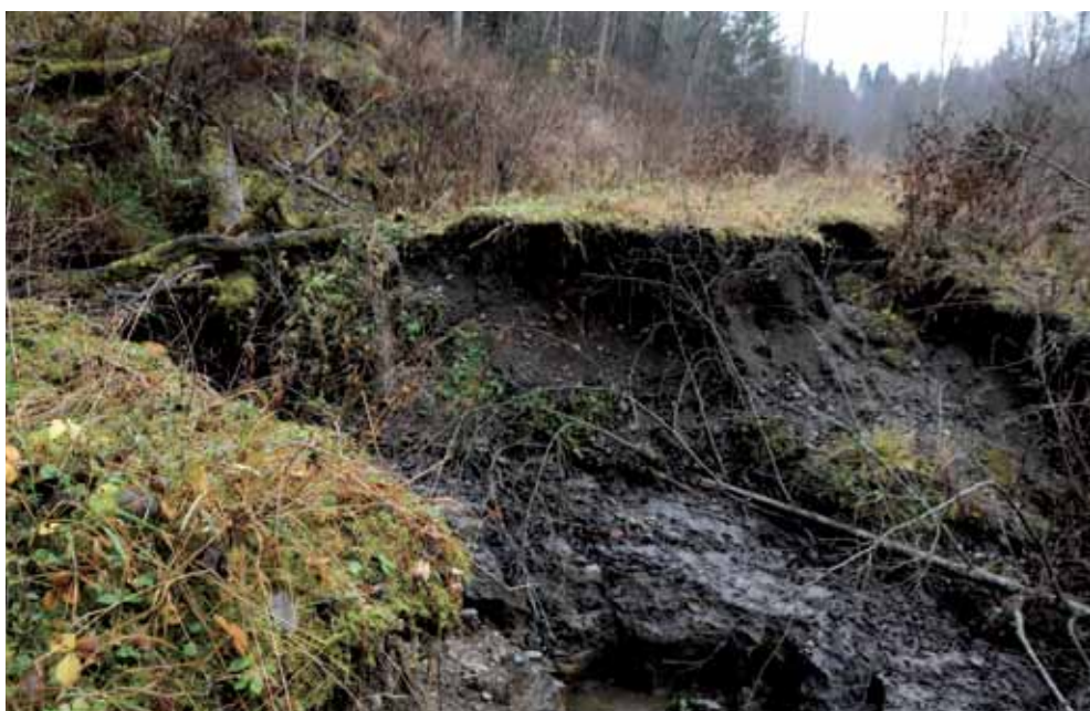
EKSTREMVÆR: Bønsparsellen har ligget der urørt siden 1944, men i år ble den på to steder tatt av ekstrem nedbør.
