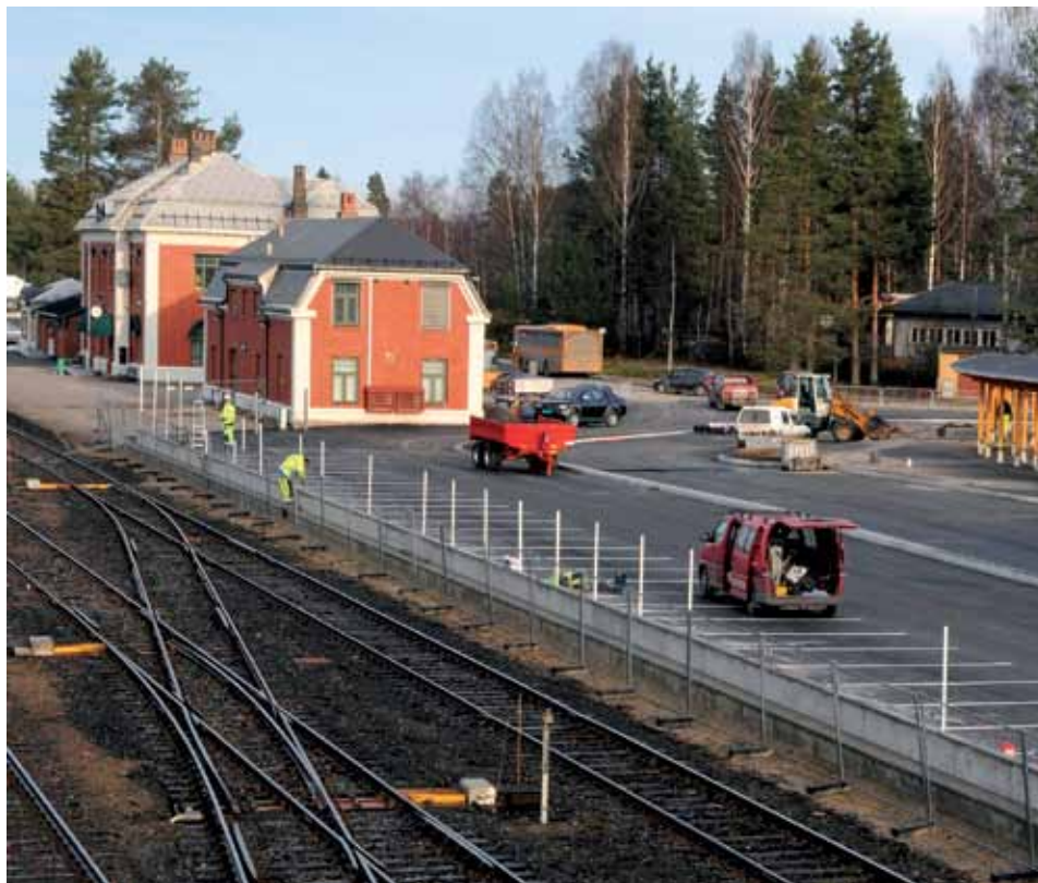
BLIR BRA: ROM Eiendom bygger mens Jernbaneverket og Hedmark Trafikk skal drifte den nye skysstasjonen på Elverum.
