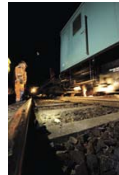
PÅ SKINNER: Etter en og en halv times sporbrudd var omformerer på plass. Tidligere ville denne jobben tatt 10-12 timer.
