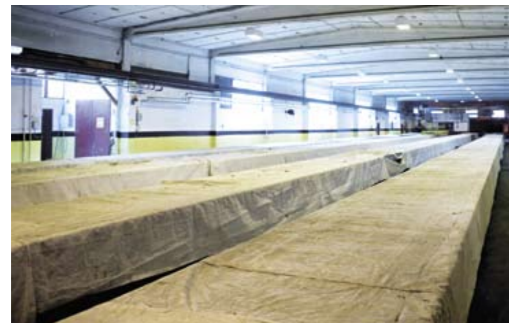
LANGBORD: Når duken som skal sikre svillene riktig herding er trukket over de ferske svillene, er det som om fabrikkhallen er forberedt til fest.
