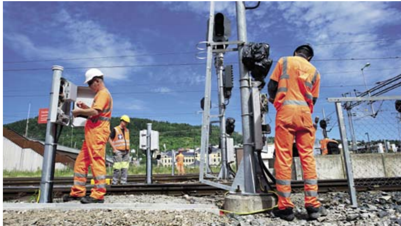
NYTT SIGNALANLEGG: Mens flytoget tidligere måtte bytte spor før det kjørte tilbake til Oslo, kan det med det nye anlegget komme inn og kjøre tilbake på samme spor.
