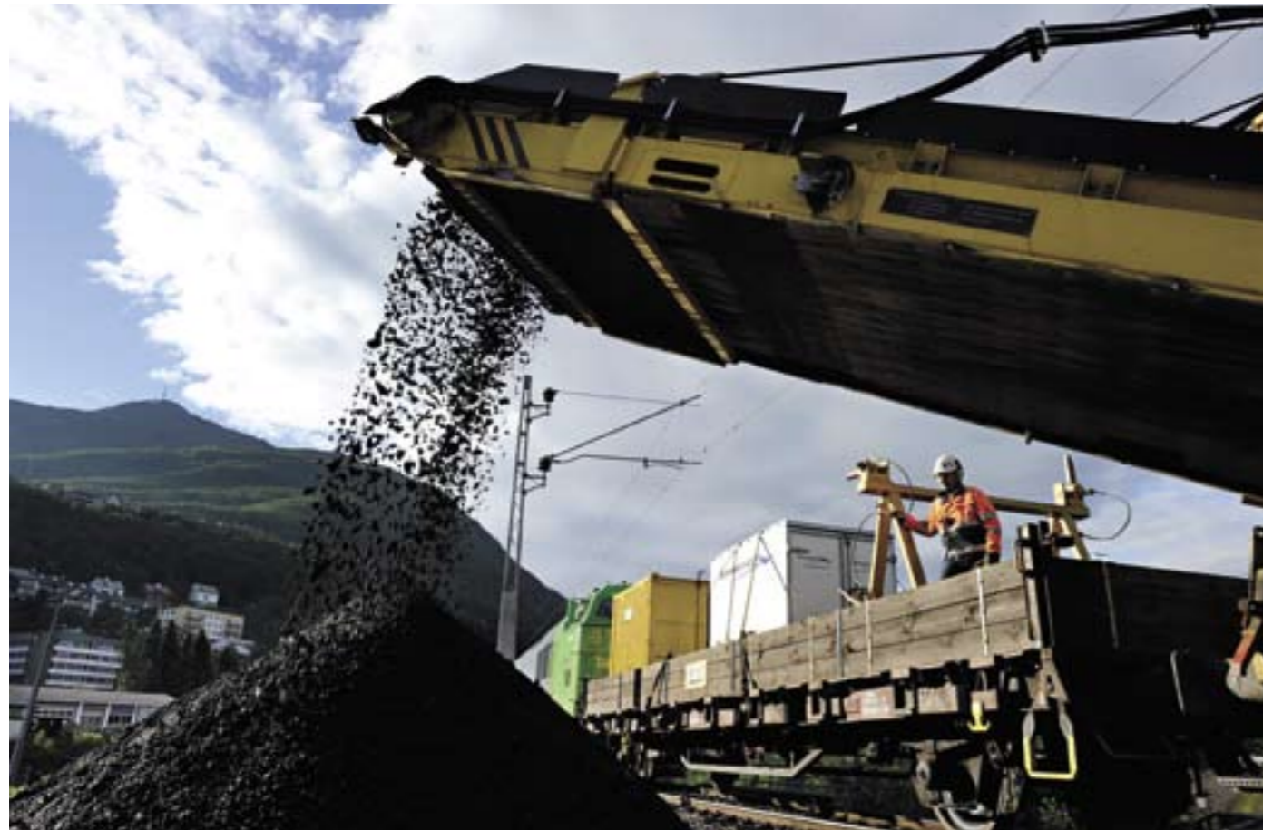
GAMMEL MASSE: Rensemassen som er sugd opp av renseverket, blir lagt i deponier langs banen eller kjørt til Jernbaneverkets driftsområde i Narvik.
