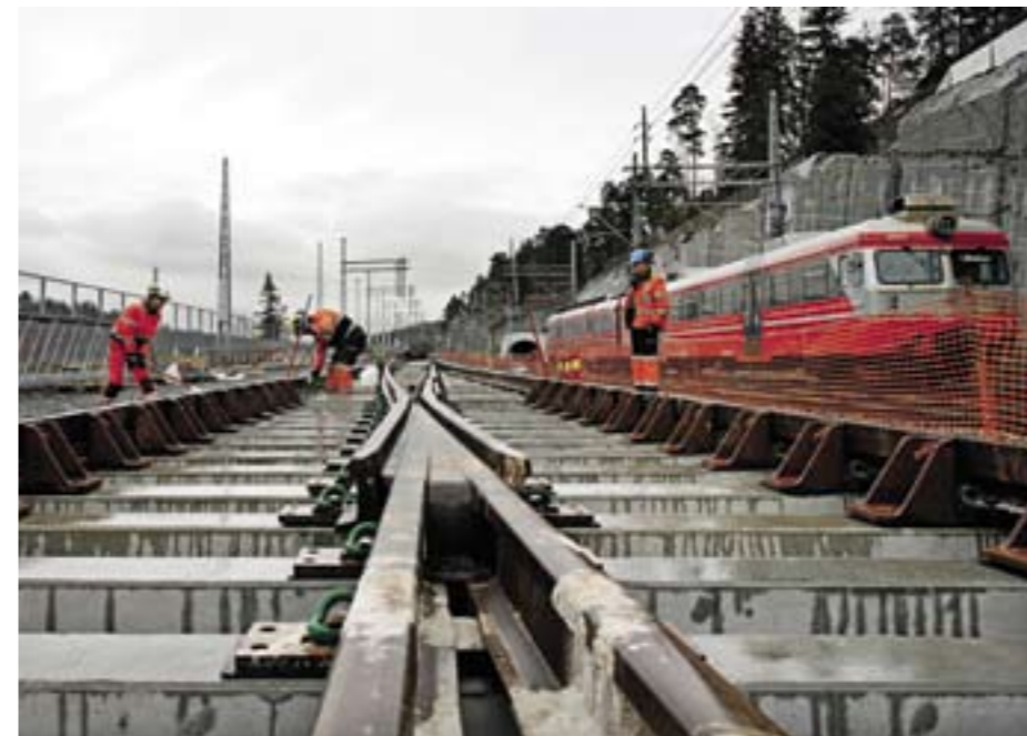
FULL SJAU: Mannskaper fra entreprenøren Baneservice i arbeid med nye sporsløyfer langs Engervannet.
