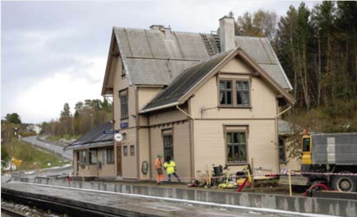
TOLGA: Arbeidet med ny plattform og oppgradering av utearealene pågår for fullt.
