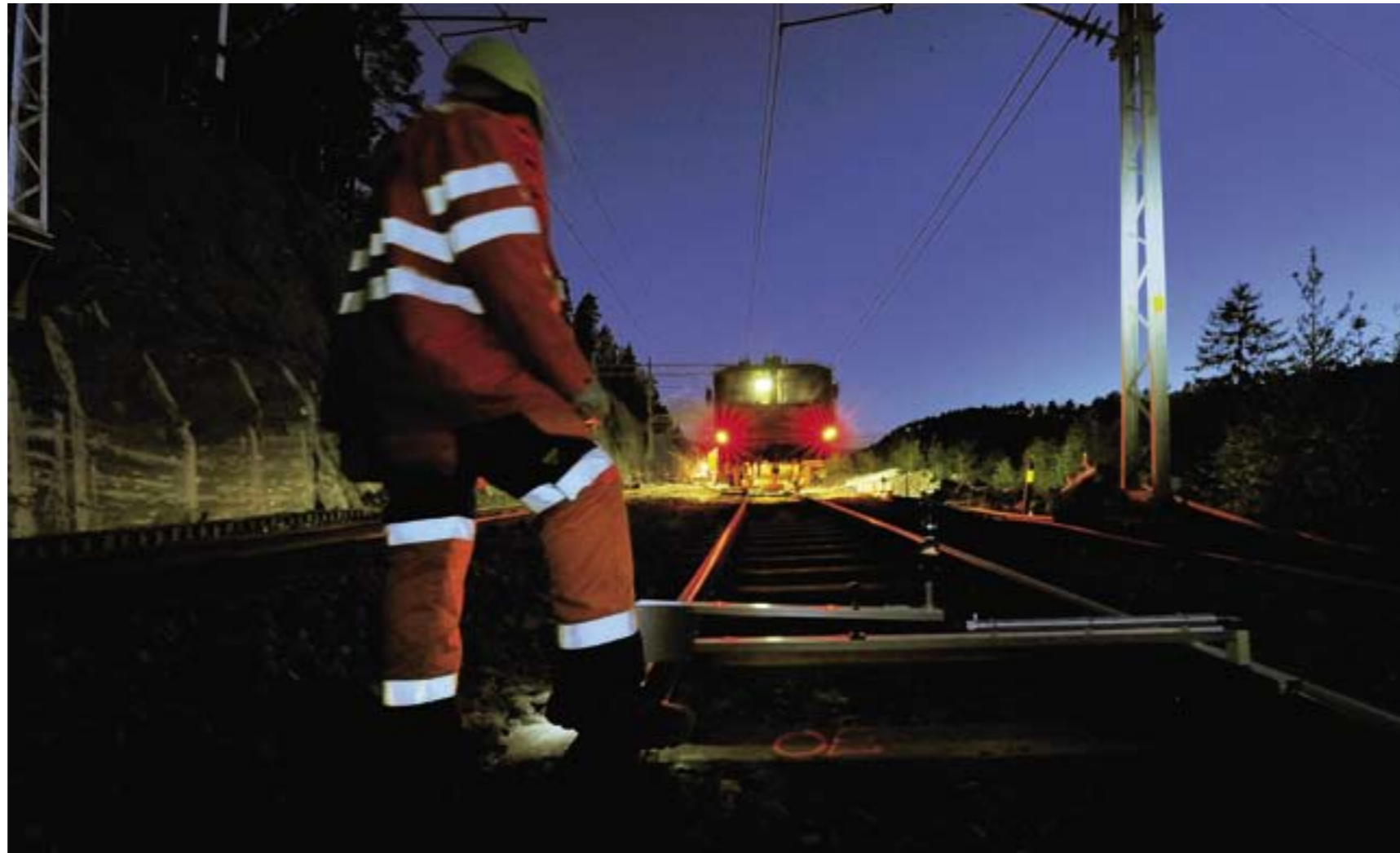
MÅLEBUKK: Øyvind Moldal i Baneservice AS plasserer målebukken på det nybygde sporet slik at oppmålingsingeniøren kan kontrollere overhøyden i kurven.
