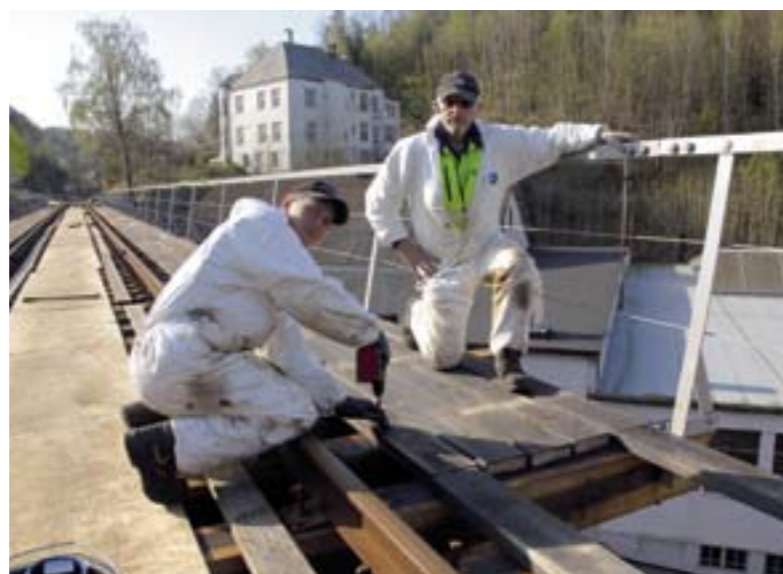
PLANKEDEKKE: Elling Ueland (t.v.) og Tor Tuen fra JBV Drift vest legger siste hånd på den nye gangbanen over Selura bru. Her legges det et planke-dekke av samme type som brua hadde tidligere.
