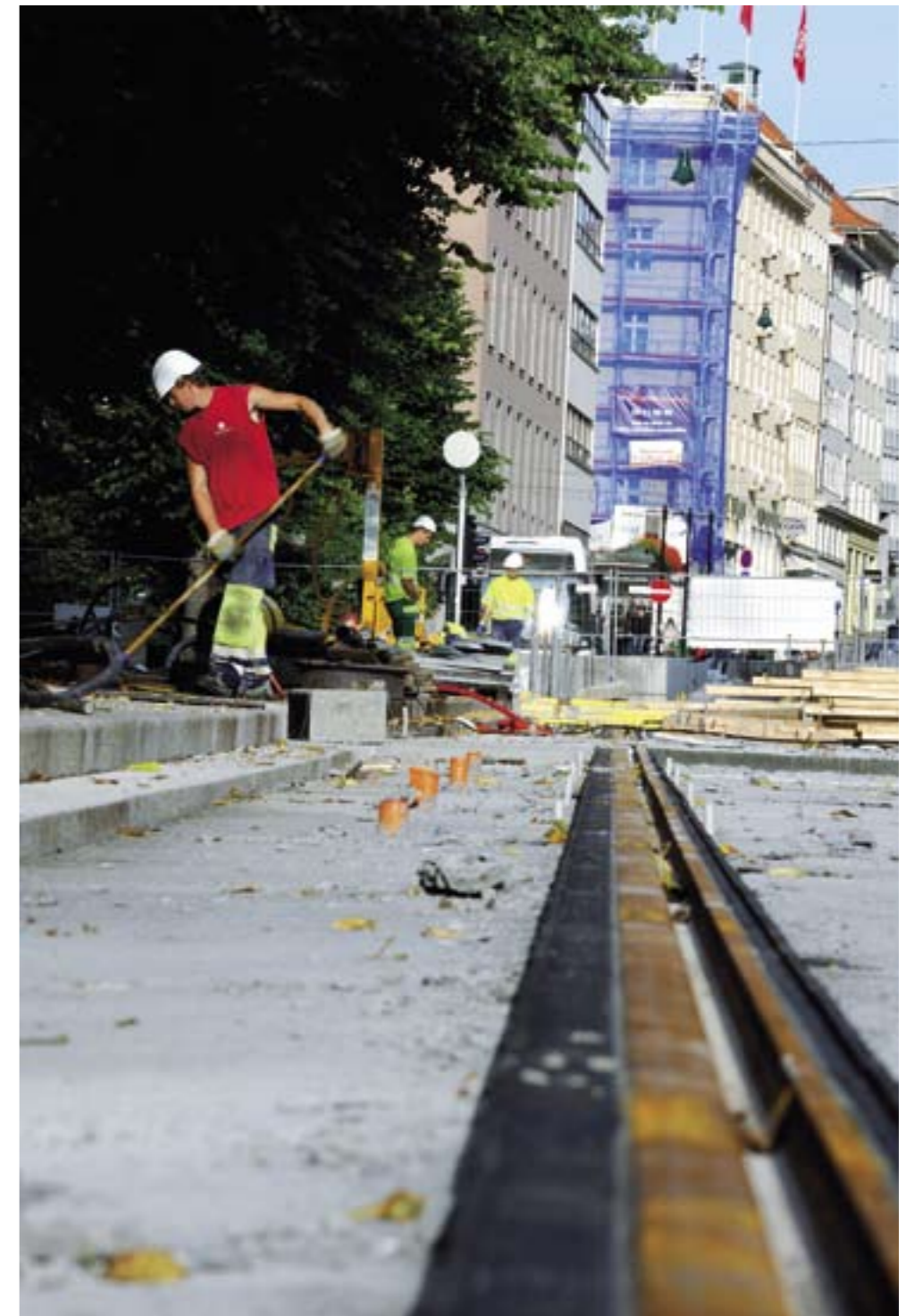
PÅ GUMMI: Skinnene støpes ned i resirkulerte bildekk for å redusere støyen fra Bybanen.
