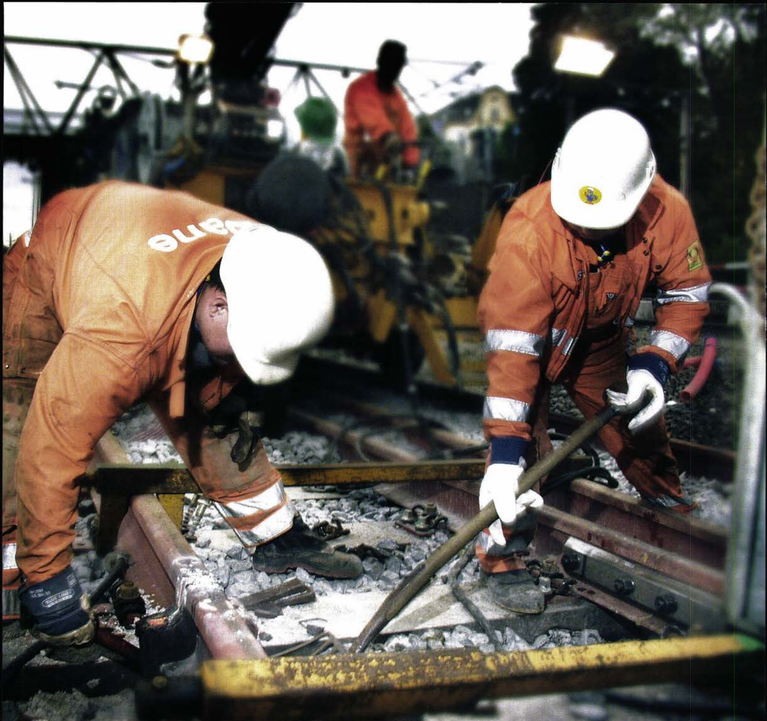
ravel sommer med å reparere nedslitte spor... Innfelt: Jernene som skal holde todelte betongsviller på plass, er rustet av.
