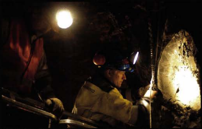
SIGNAL: I Gruatunnelen henger KL-montør Per Kristian Lyngen (t.h) og sikkerhetsmann Erling Mathisen opp antenne for ny GSM-R togradio.
