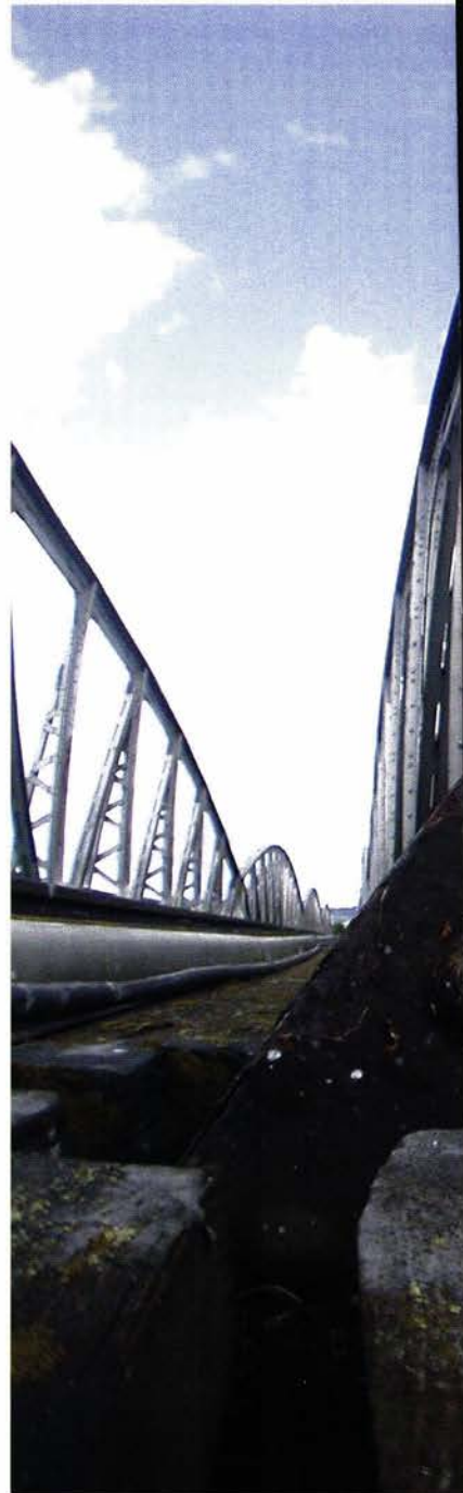
RÅTE OG RUST: På jernbanebrua over St
