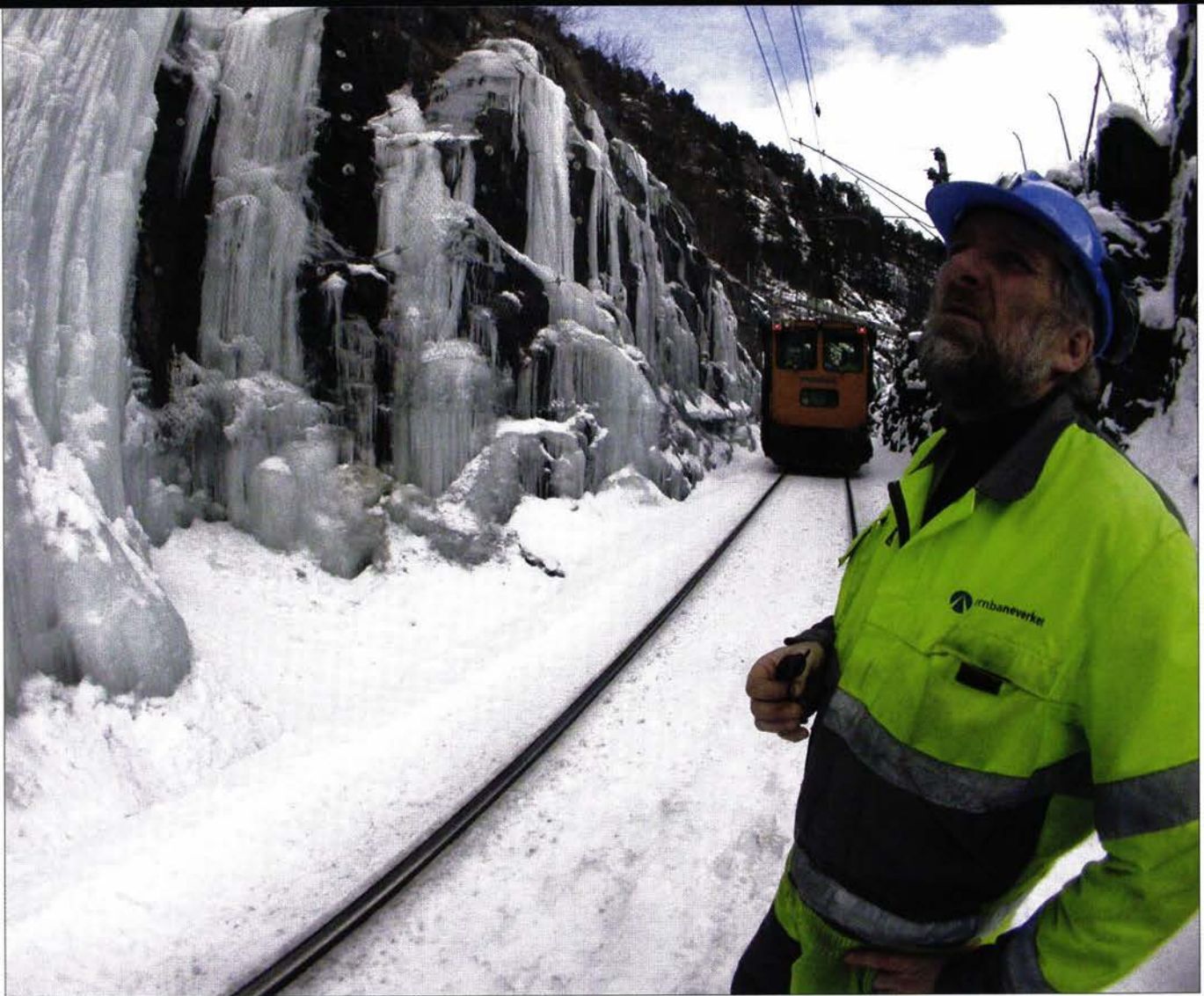
Sikres: Byggeleder Knut Helge Byrkje er engasjert for å sikre Bergensbanen mot is- og steinsprang mellom Myrdal og Voss. Til sammen er 4200 kvadratmeter rasfarlig fjell sikret i løpet av to år.
