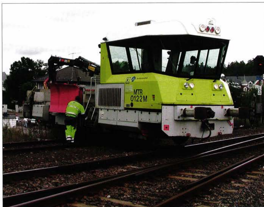
Vendes: Kockums-tralla i Tønsberg. Arbeidsmaskinen kan vendes på fri linje ved å løfte seg selv rundt ved hjelp av en plate som felles ned på skinnegangen. (Foto: Njål Svingheim)
