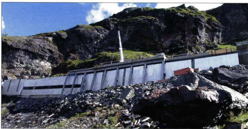
Sikres: Steinblokker fra et av fire ras taler sitt tydelige språk, og nybygget monteres over eksisterende snøoverbygg, som senere skal fjernes.
