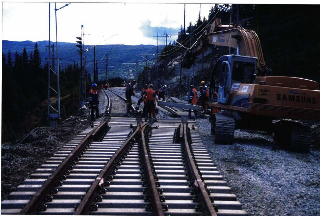
Urovekkende: Kostnadene til bygging av nye eller oppgardering av gamle kryssingsspor er blitt urovekkende høye. Bildet er fra Gulsvik kryssingsspor på Bergensbanen, som ble forlenget i 1999. (Foto: Øystein Grue).
