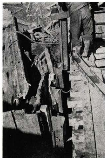
Fig. 8. Ekstra stålsponsvegg rammes utenfor tresponsvegg på nordsiden av Bru 5 for å sikre byggegrop og ovenforliggende labil skråning. 21. september 1955.
