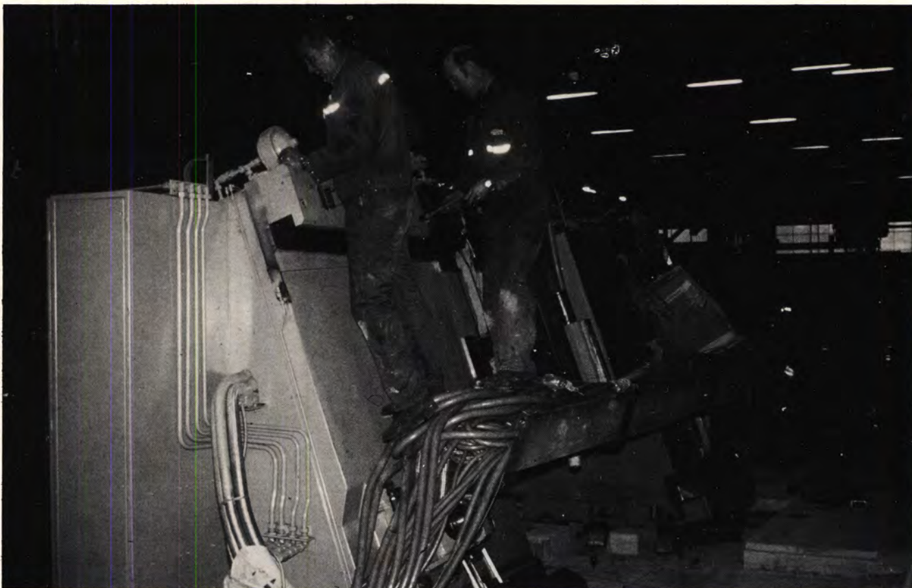
Fig. 5. Fra monteringsarbeidet. Selve portalen er på plass. Den veier 23,5 tonn. Odd Andersen og Gunnar Hardal i arbeid.
