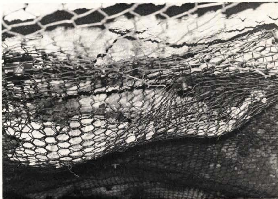
Fig. 3. Sikringsnett fyllt med nedfallen stein.
